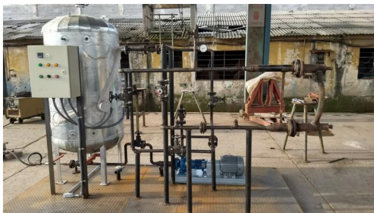
Figura 4-18 Vista lateral derecha del Sistema Emulador Geotérmico.
