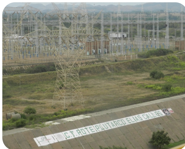
FIGURA 21. Torres de transmisión eléctrica, Central Termoeléctrica "Petacalco", 2016. Fuente: Colección propia
