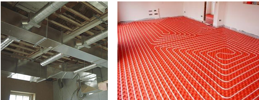
Figura 1-25- Sistema de distribución de energía. Aire forzado (lado izquierdo) y piso radiante (lado derecho).
