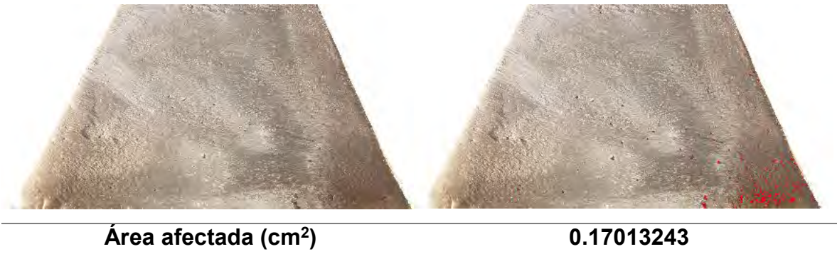
Figura 8.99 Área afectada de la zona 4A.
