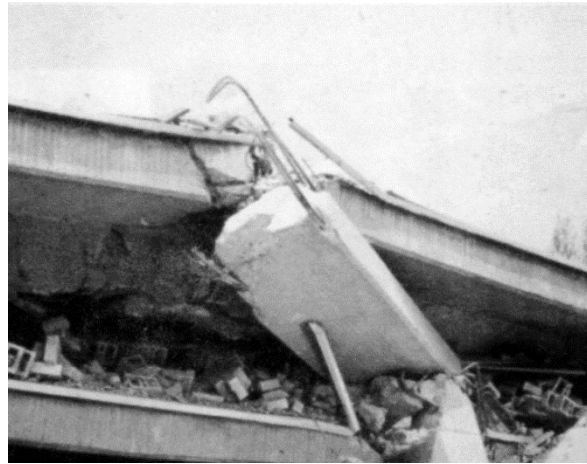
Figura 1.13. Falla en unión por escasez de anclaje en la conexión de la columna con el sistema de piso (México 1985) (Bazán y Meli, 2001)
