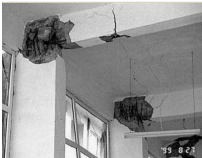
Figura 1.3. Daño en traves de concreto reforzado (Armendáriz, 2015)
