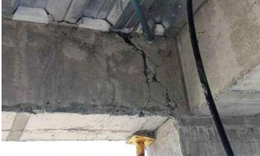
Figura 1.4. Agrietamientos diagonales en los extremos de la viga (Mieles Bravo, 2016)
