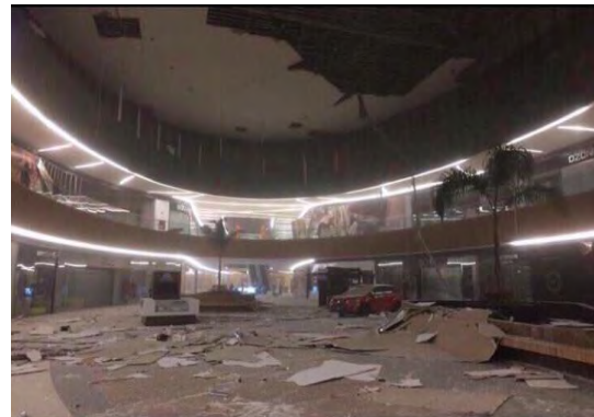
Figura 1.17. Daño no estructural (Chiapas, 2017)
