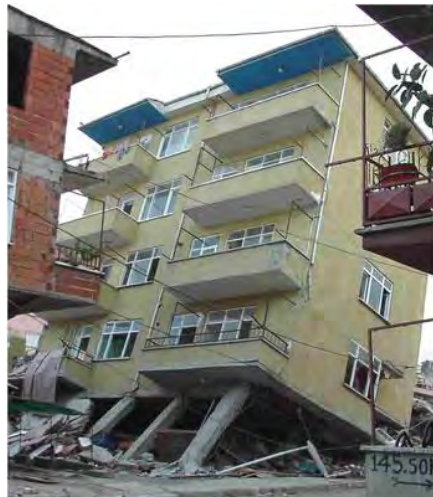
Figura 1.23. Falla del edificio debido a grandes deformaciones laterales por planta baja débil (Cogurcu, 2015)
