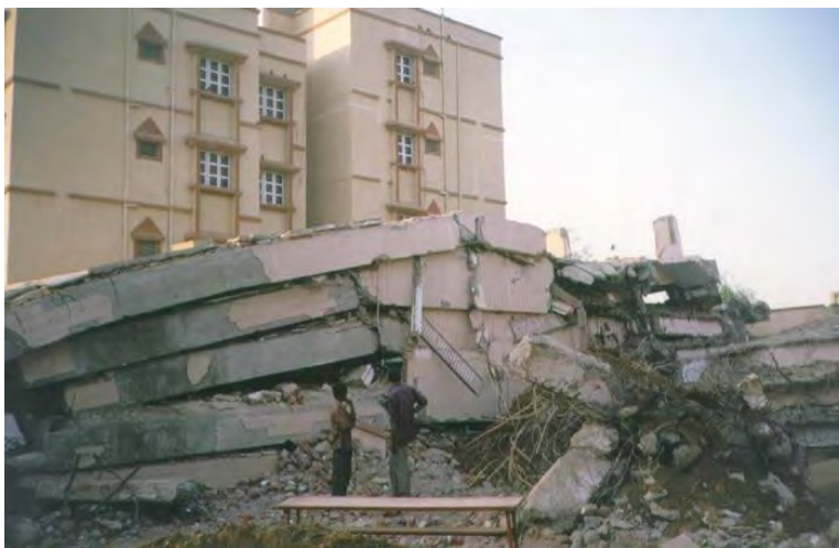
Figura 1.19. Colapso total de un edificio como resultado de sistema estructural “vigas fuertes – columnas débiles”
