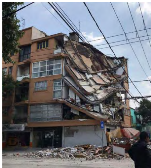
Figura 1.22. Colapso de edificio de esquina ocasionado por irregularidad de la planta (México, 2017) (CENAPRED, 2017)
