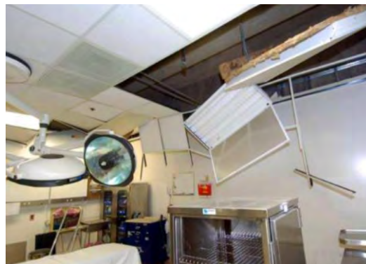
Figura 1.18. Daño en contenidos en hospital
