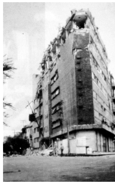
Figura 1.2. Daño en edificio durante el sismo de México 1985 (Bazán y Meli, 2001)
