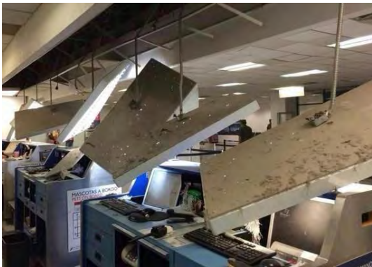
Figura 1.16. Daño en instalaciones
