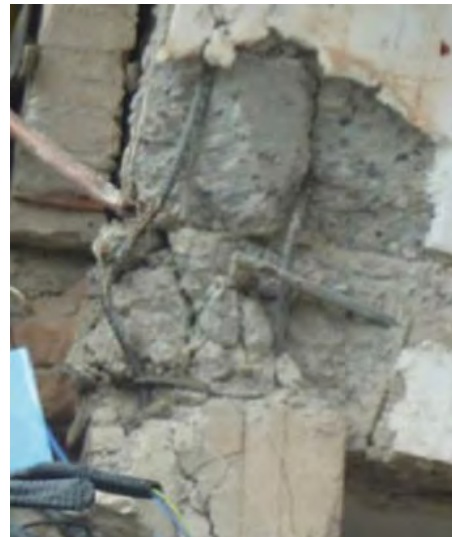
Figura 1.8. Detallado sísmico deficiente en unión viga – columna (Manfredi et. al. , 2014)
