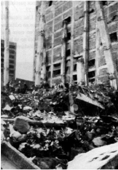
Figura 1.9. Falla por punzonamiento de la losa en un edificio estructurado a base de losas planas (Bazán y Meli, 2001)
