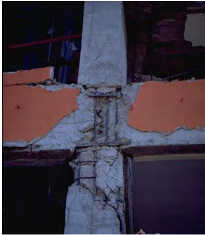
Figura 1.12. Desprendimiento del concreto por falta de refuerzo transversal en la unión viga – columna
