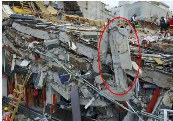
Figura 1.11. Colapso por punzonamiento de la losa (CENAPRED, 2017)
