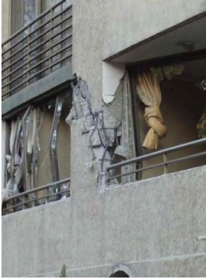
Figura 1.26. Columna corta por restricción impuesta por muros (Saatcioglu et. al. 2013)
