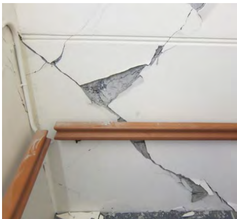
Figura 1.14. Agrietamiento diagonal en muros de cortante
