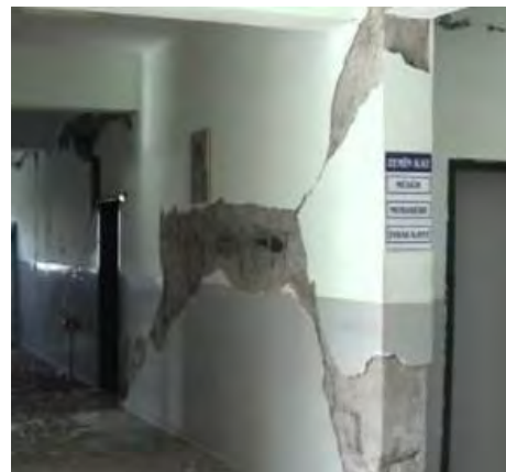
Figura 1.15. Falla por cortante en muro de cortante (Turquía, 2003)
