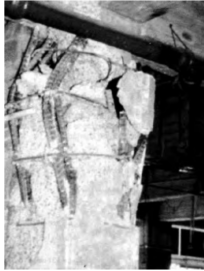
Figura 1.6. Falla de columna por deficiente armado de la sección (México 1985) (Bazán y Meli, 2001)
