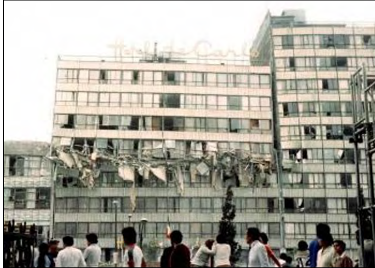
Figura 1.20. Daño por golpeteo entre estructuras adyacentes (El daño se agrava cuando no coinciden en altura) (México, 1985)
