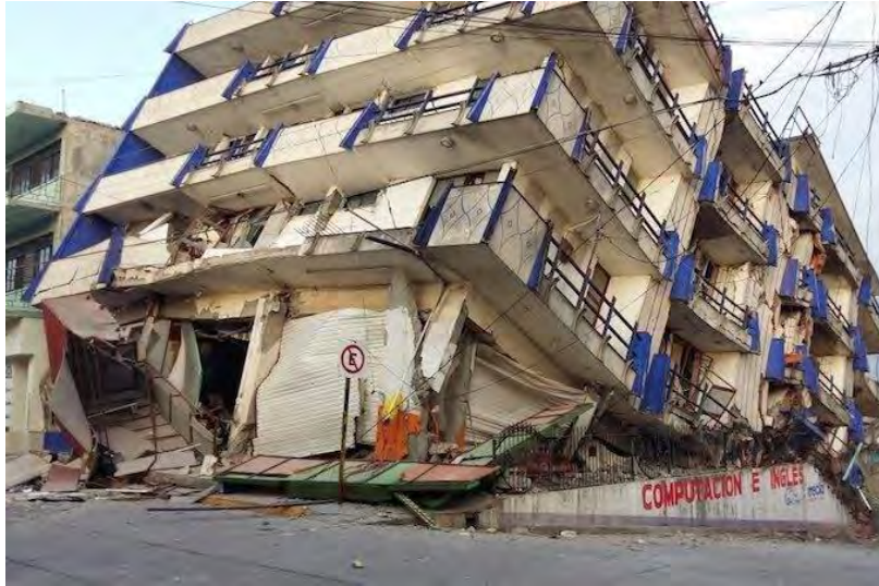
Figura 1.24. Colapso por planta baja débil (Sismo de Chiapas, 2017)
