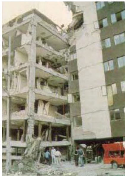
Figura 1.1. Daños severos en edificios de concreto durante el sismo de México 1985 (Soto, 2008)
