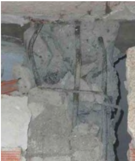
Figura 1.7. Confinamiento inadecuado del concreto por gran espaciamiento de estribos, además no se cerraron a 135° (Baran et. al , 2014)
