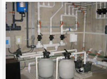
Cuarto de Máquinas https://goo.gl/LZNXeT
