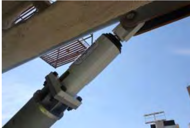
Figura 1.7 Amortiguador viscoso instalado en la Torre Ejecutiva de la Secretaría de Economía de la Ciudad de México. Fuente: MAGEBA.
