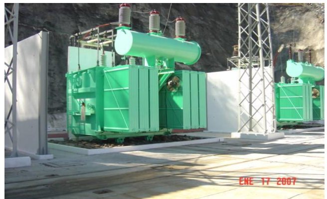
VISTA DE LOS TRANSFORMADORES PRINCIPALES
