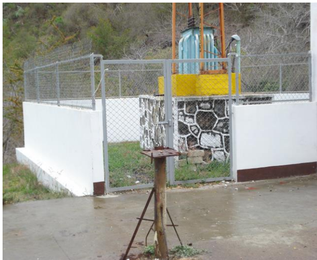
ÁREA DE TRANSFORMADOR CAMPAMENTO
