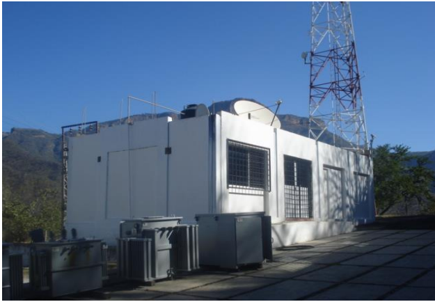
CASETA AMPLIACIÓN PISO TRANSFORMADORES
