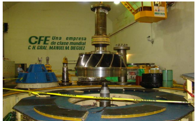
ASPECTO DEL DESARMADO DE LA TURBINA U-1
