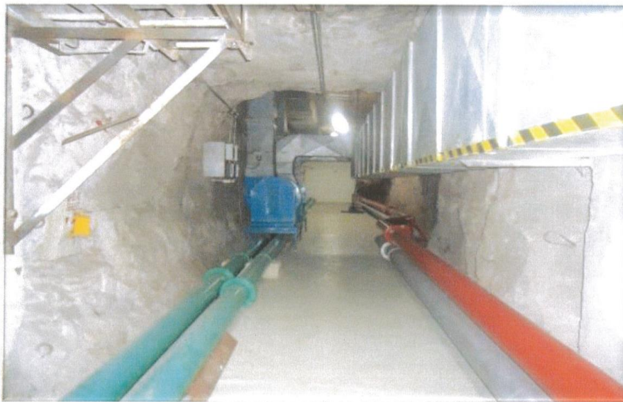
TRABAJOS CONCLUIDOS EN EQUIPOS DE PISO DE VALVULAS Y TUNEL DE EXPLORACIÓN
