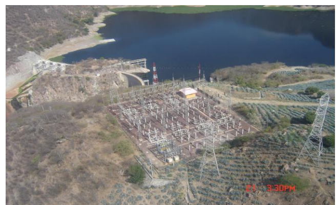
VISTA AEREA SUBESTACIÓN SANTA ROSA
