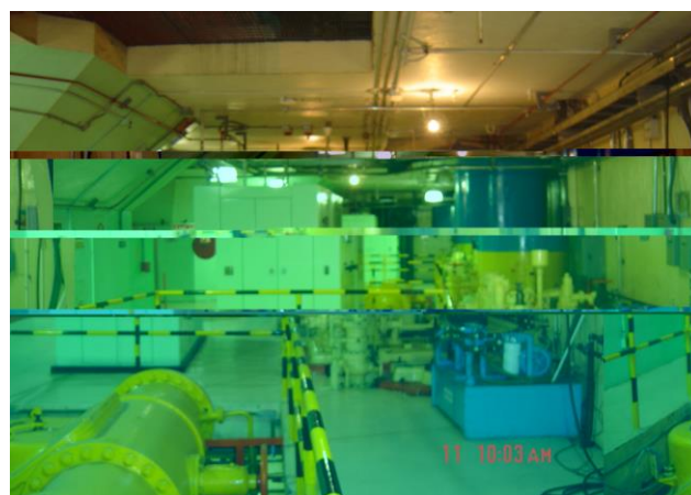
PISO DE TURBINAS
