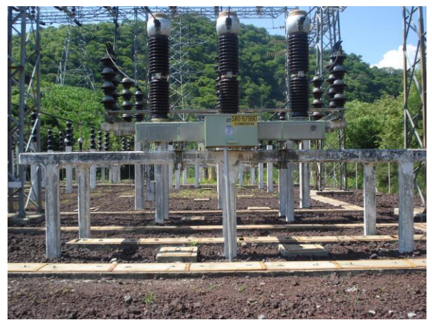
SUBESTACIÓN ELÉCTRICA SRO
