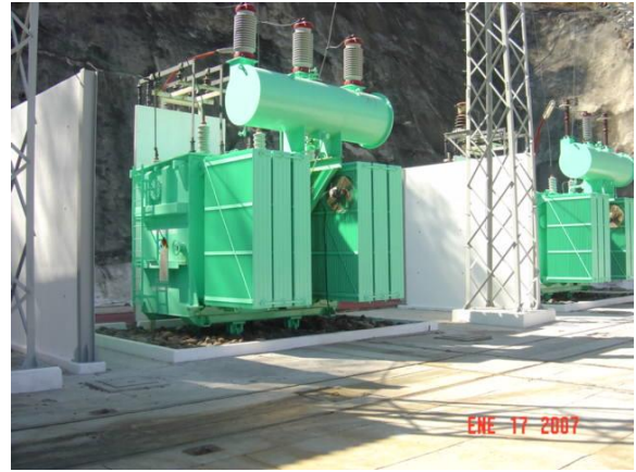
AREA DE TRANSFORMADORES
