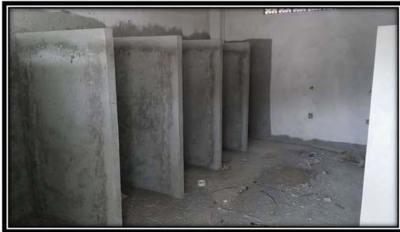
FIG.36. Imagen tomada en la “Casa Hogar del Niño de Acapulco” referente al EDIFICIO-4 . Sanitarios y regaderas en construcción.
