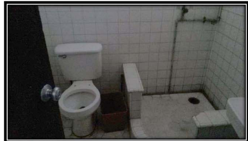
FIG.19. Imagen tomada en la “Casa Hogar del Niño de Acapulco” referente al EDIFICIO-2. Baño y regadera de habitación de los niños.
