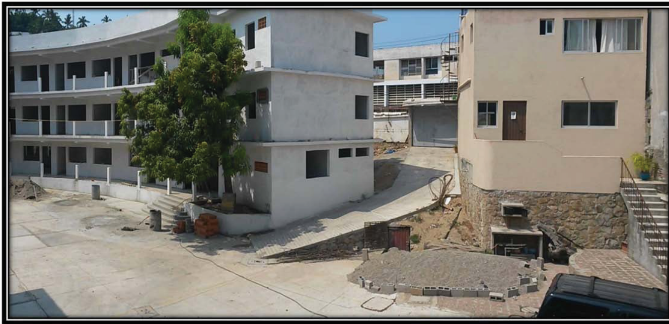
FIG.32. Imagen tomada en la “Casa Hogar del Niño de Acapulco” referente al EDIFICIO-4 . Vista exterior del edificio, se encuentra actualmente en construcción (edificio color blanco).
