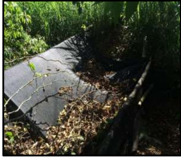
Foto 26. Obstrucción y represamiento del agua.
