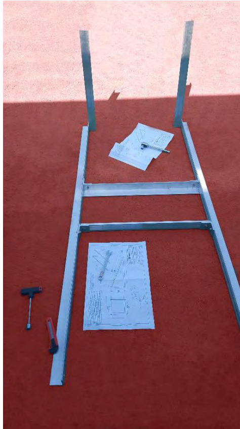
Figura 5.5. Estructura metálica, plano y torquímetro.
