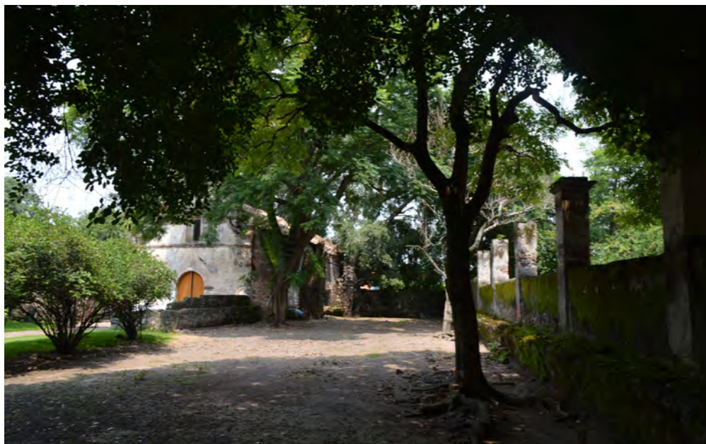
Gráfico 66. Vista de los jardines y muro perimetral de piedra y ladrillo invadido por vegetación (musgo).
