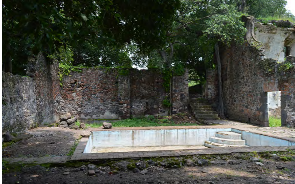
Gráfico 52. Alberca en desuso y con filtraciones en zona de habitaciones.
