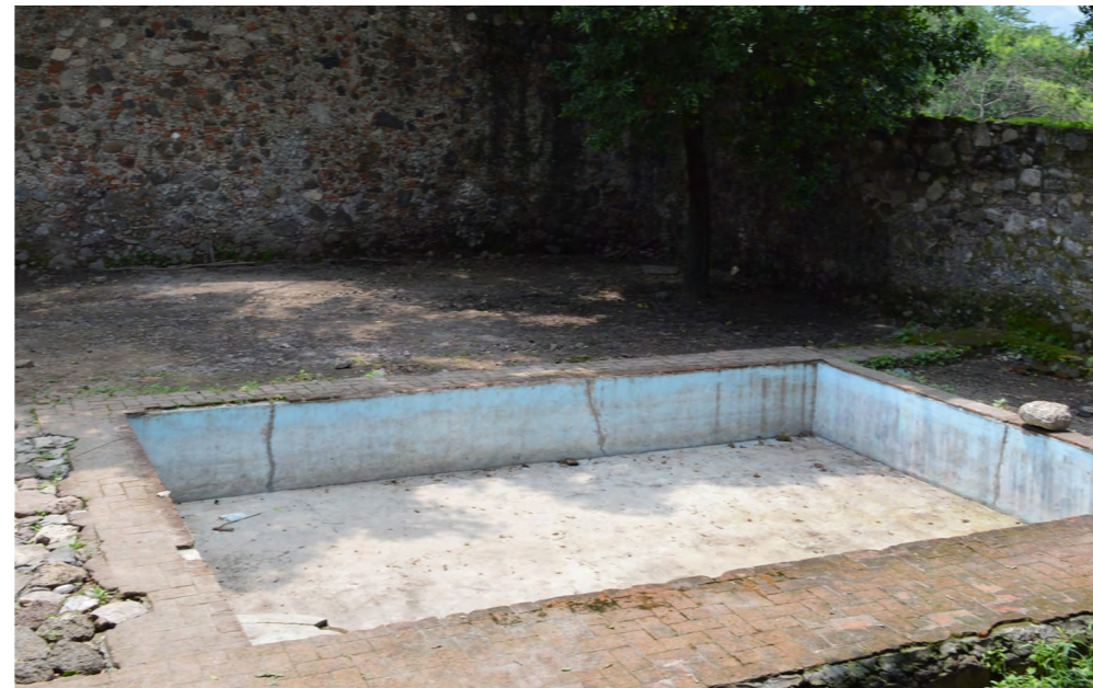
Gráfico 51: Alberca en desuso y con filtraciones en zona de habitaciones.
