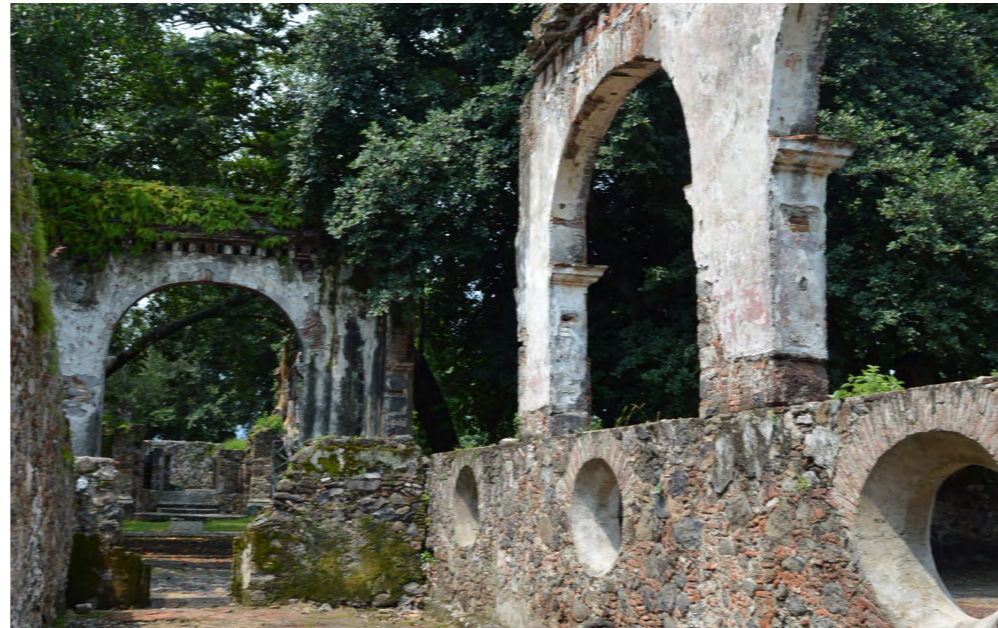
Gráfico 81. Vista de arcos rebajados en estructura de la casa principal, invadidos de vegetación (helechos pequeños y musgo).
