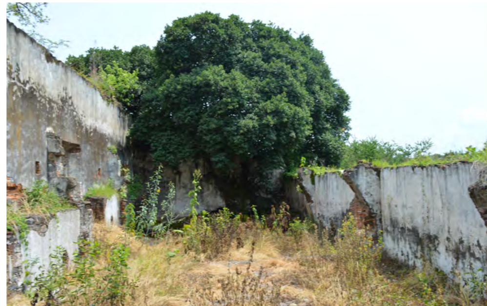
Gráfico 71. Interior de uno de los galerones, muros invadidos de vegetación en la parte superior, conservan el recubrimiento en su mayoría, vegetación agreste en suelo .
