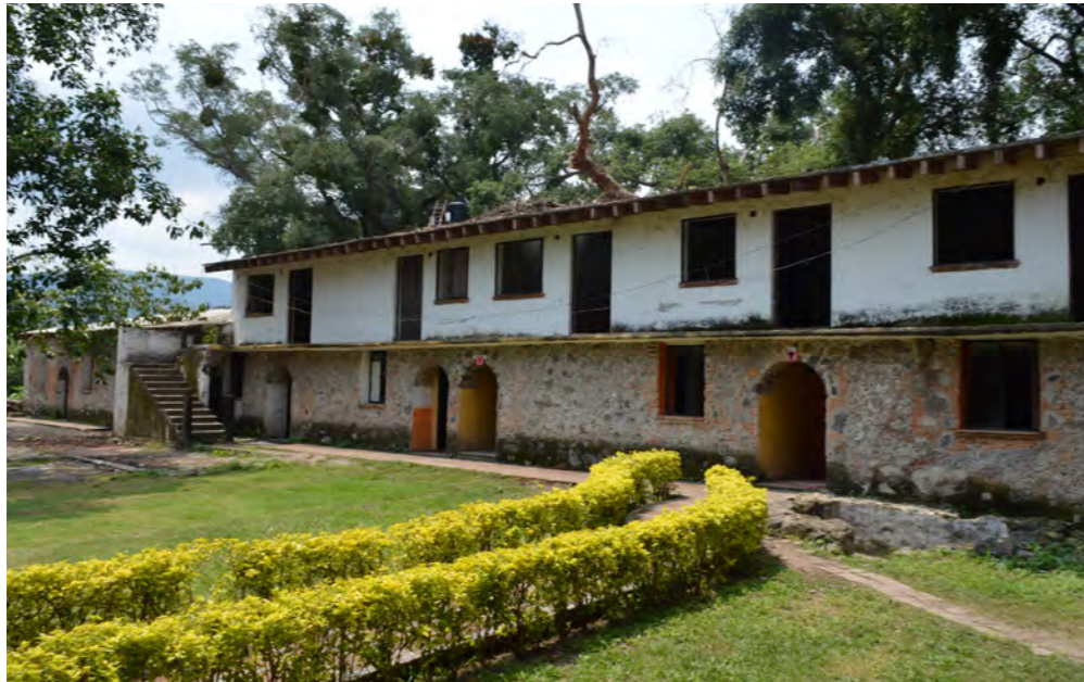
Gráfico 56. Zona habitacional de huéspedes, construcción reciente. En la planta baja se encuentran baños comunes, la cubierta presenta desgaste estructural y derrumbes.
