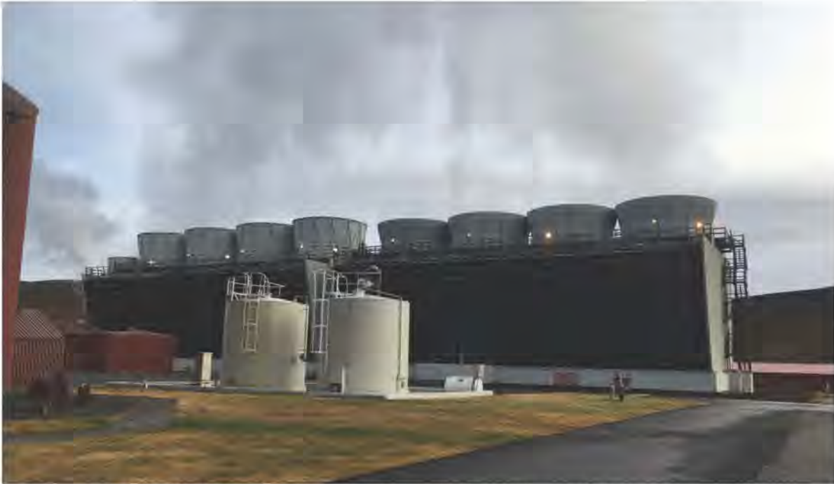
Figura 2. 1 Torres de enfriamiento de la planta geotérmica Krafla, Islandia. Fuente: Archivo de la autora (2016).
