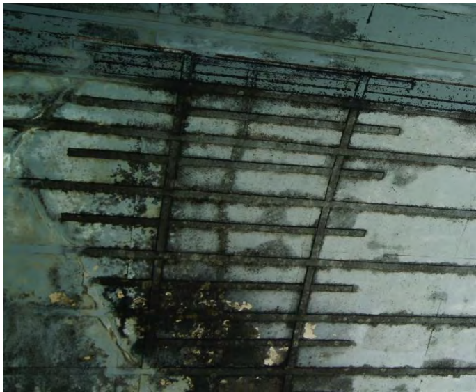
Figura 58. Foto de las condiciones actuales de las reparaciones. 2017. Ing. Pedro Solano
