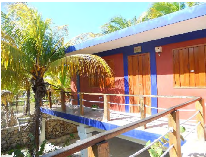
Figura 50. Fotografía ala oeste de la vivienda. Asociación de anomalías con el ambiente y el uso.
