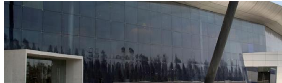
Figura 18. Muro cortina en fachada de Expo Bancomer Santa Fe. http://www.exposantafe.com.mx/esfm/index.php/es/fotos-video-2 . Consultado el 20 de marzo del 2016.
