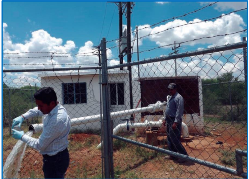
Calidad del agua en el sistema de distribución
