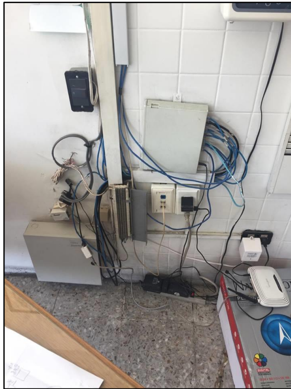
Ilustración 11. 3COM SW16, TP-Link Edif. San Marcos. Los equipos 3COM SW16 y el TP-Link, se encuentran empotrados sobre la pared, casi en la entrada de las instalaciones del edificio de San Marcos, por lo que la exposición de estos equipos representa un riesgo en la seguridad física, seguridad lógica, la disponibilidad de los servicios.
