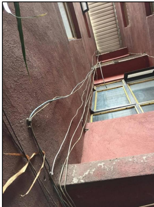
Ilustración 13. Trayectoria del cableado edif. Santa Isabel PB a P2. El recorrido del cableado en el exterior se encuentra sin canalizar, lo que puede perjudicar el estado físico del cable, teniendo como consecuencia perdida en la conexión.
