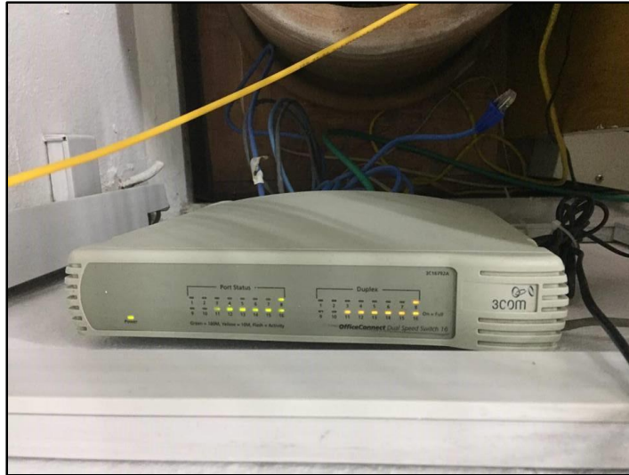
Ilustración 9. 3COM SW 16 Edif. Santa Isabel > PB >Dirección. Switch 3COM empotrado sobre la pared el cual presenta fallas en el adaptador de corriente. La falla de este equipo provoca que los dispositivos de la planta baja del edificio de santa Isabel quedé inactiva, así como la pérdida de conectividad a internet a los dispositivos del segundo piso y del edificio de San Marcos.
