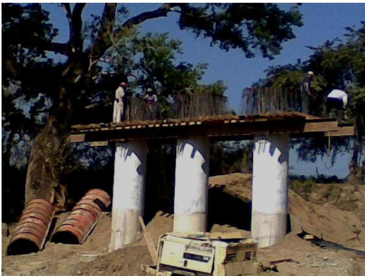
Foto No. 58 Cimbrado de fondo del cabezal de un caballete, se observa que se utilizaron vigas metálicas de obra falsa.
