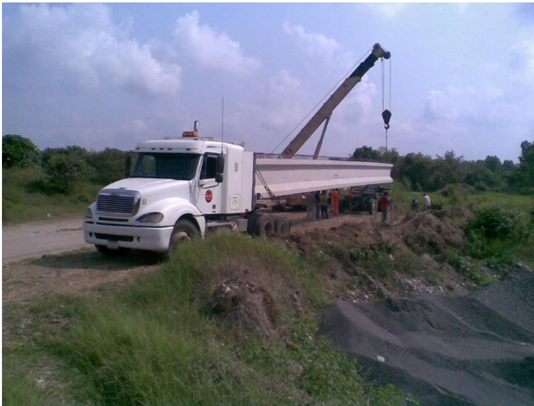
Foto No. 84 Se habilitaron algunos espacios para poder estibar las traveses en el sitio de la obra.
