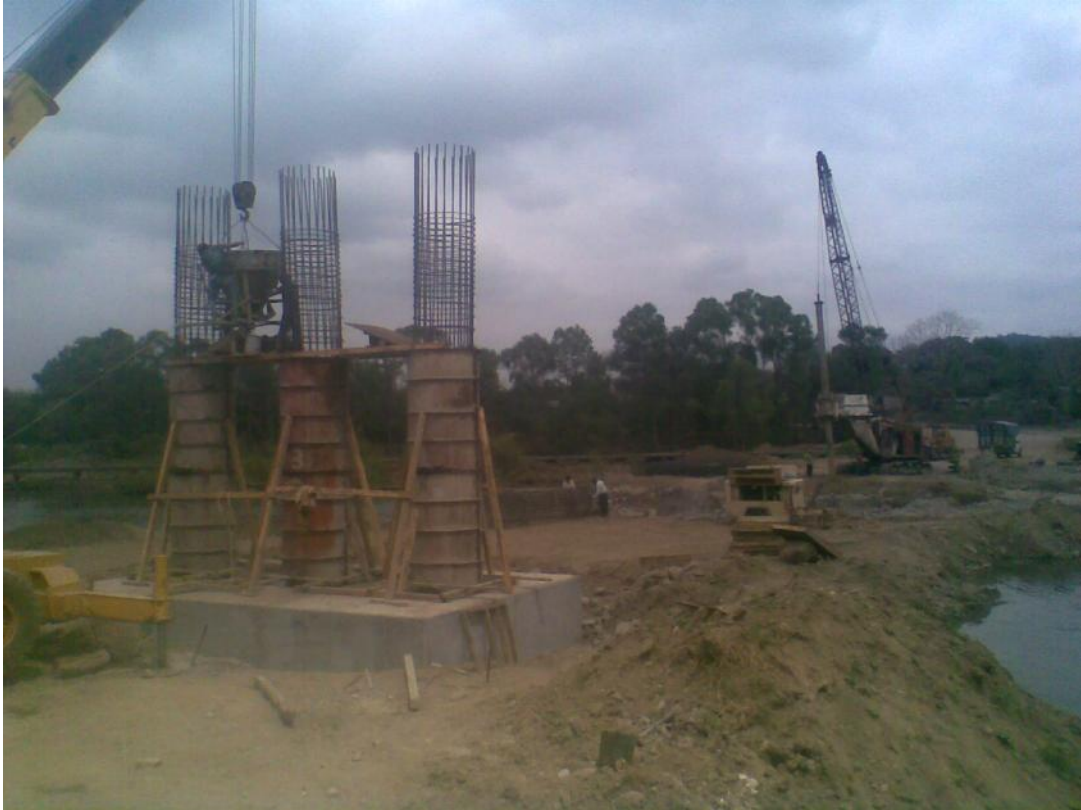
Foto No. 50 Se observa el cimbrado de columnas en tramos de 4 metros, se cimbra y se cuela con bacha el mismo día las tres columnas.
