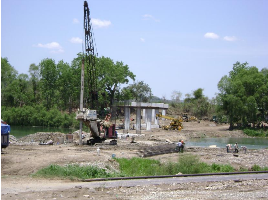
Foto No. 21 Trabajos de perforación en apoyo 3 y se observa que se está realizando el armado en la área de la perforación para colocarse inmediatamente terminada el pilote.
