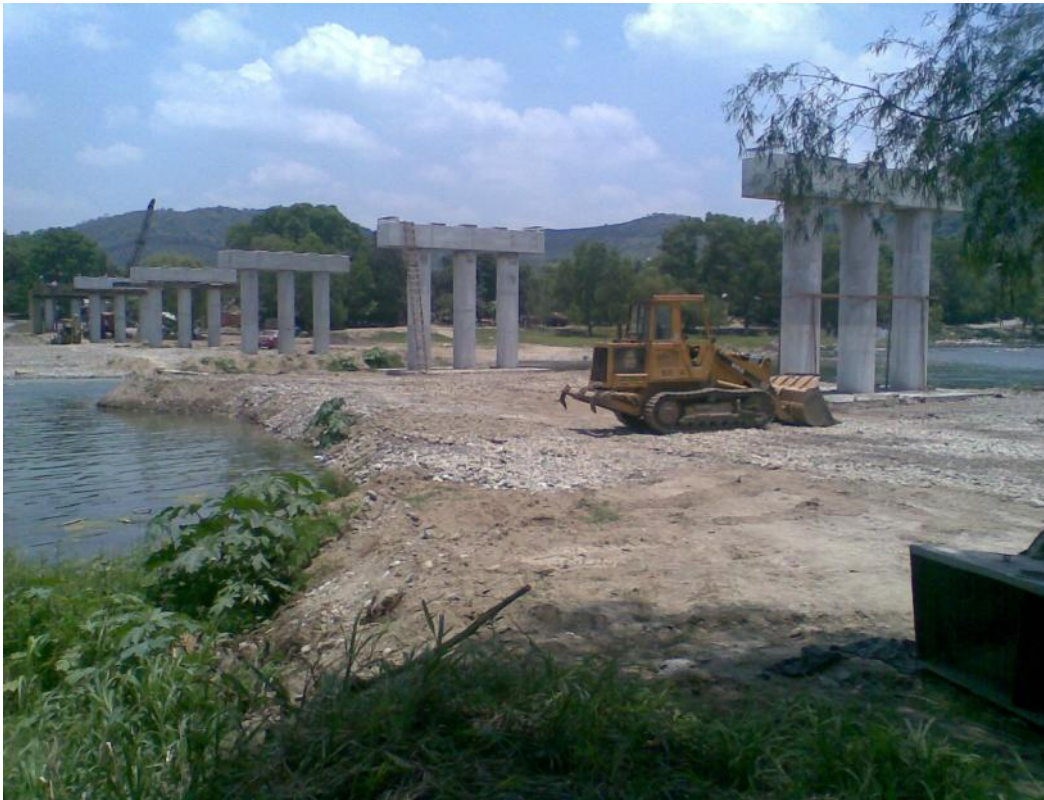
Foto No. 85 Mientras se acarreaban las traveses se fue preparando la plataforma con revestimiento para el montaje y mejoramiento de accesos.
