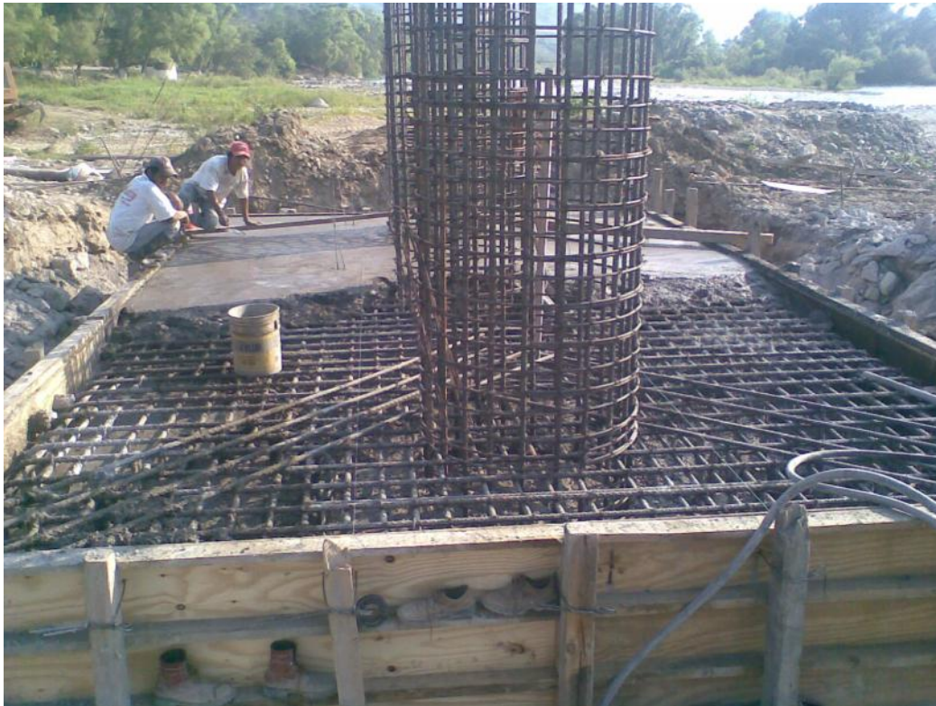
Foto No. 42 Se va nivelando el concreto conforme se va llegando al nivel con regla y cuchara de albañil.
