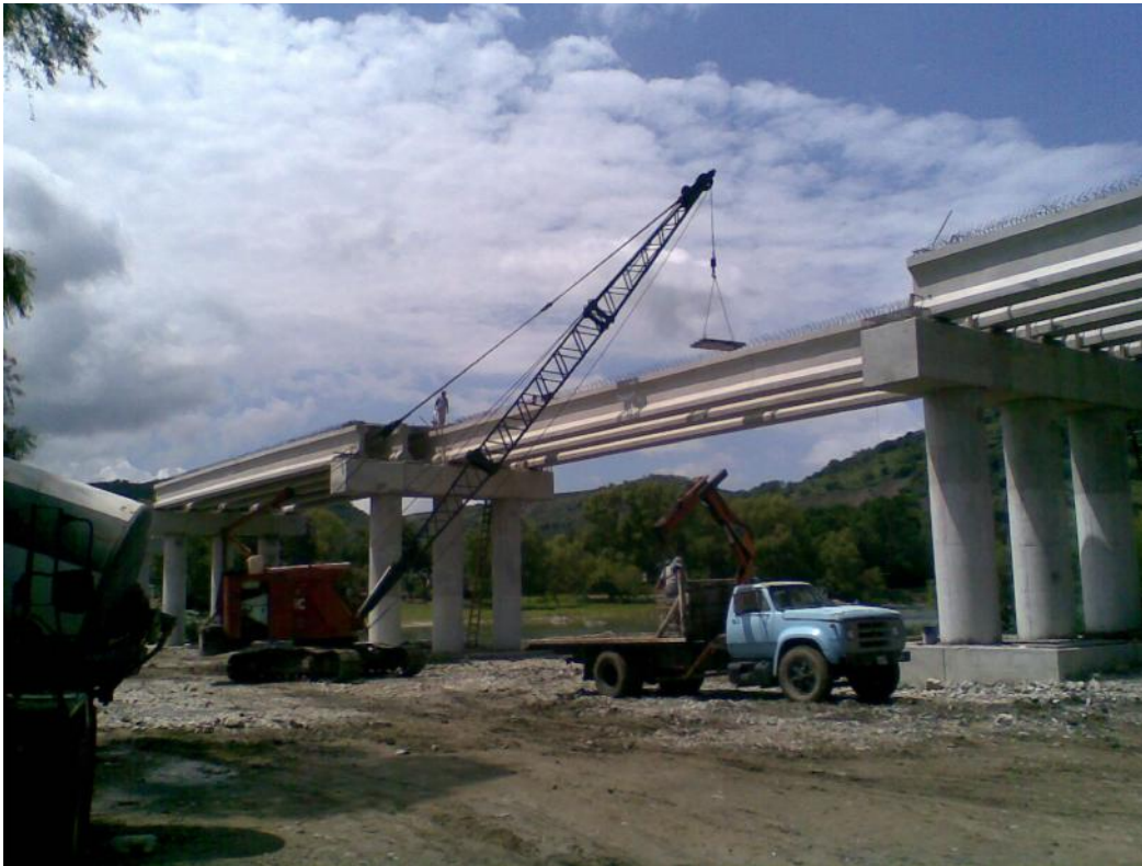
Foto No. 108 Manera de como se colocan las prelosas con draga y camión Hiab.
