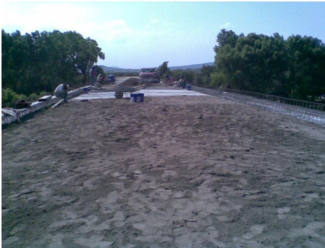
Foto No. 131 Losa después de vaciar el concreto y protegerla para que no pierda humedad y no se agriete.
