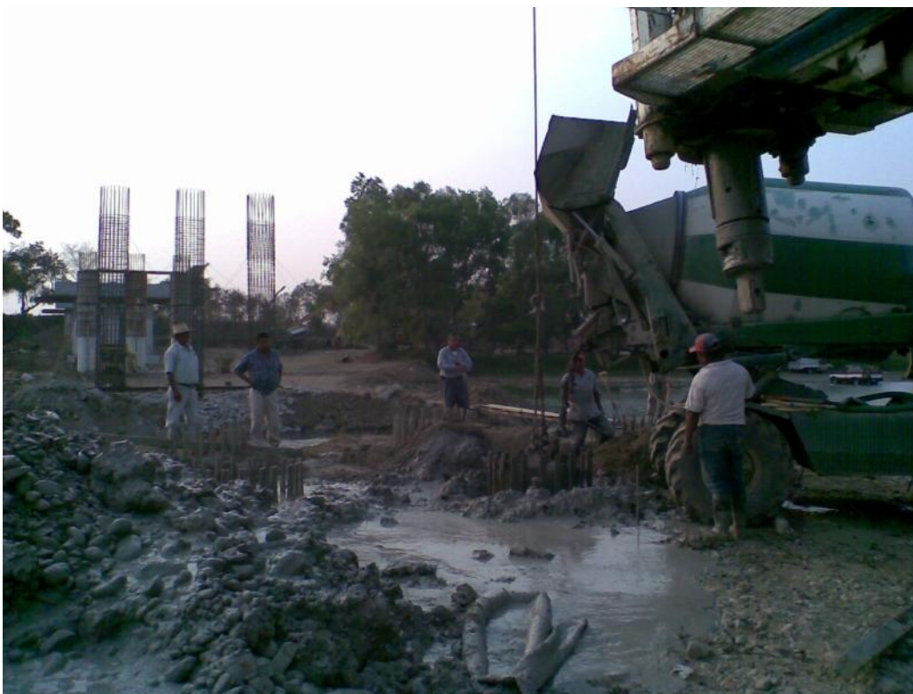
Foto No.28 Se observa el colado de pilote con la autohormigonera, ya no coloco el canalón para que le permitiera el chaqueteo del tremie y el acomodo del concreto.
