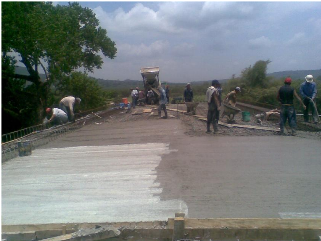
Foto No. 126 Vaciado y acomodo del concreto de losa, así como la colocación de curacreto en donde ya se pueda aplicar para evitar pérdida de agua.
