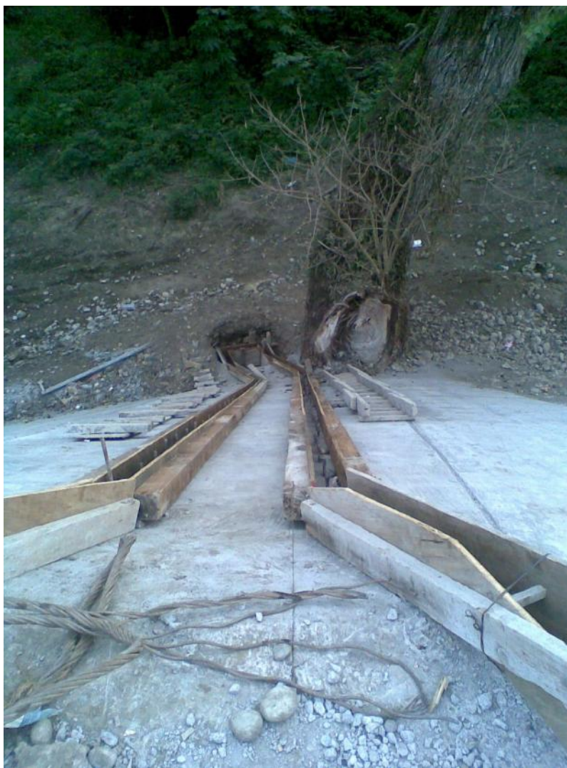
Foto No. 194 Lavadero cimbrado con varillas de anclaje y al fondo se observa la caja de disipación.
