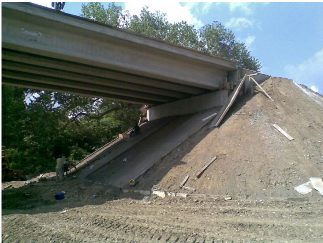
Foto No. 183 Losas del cono de derrame debajo del puente, y como se ven están salteadas.
