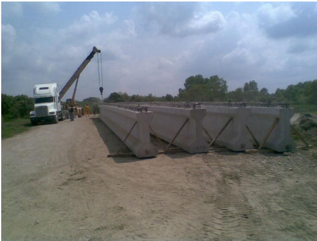
Foto No. 82 En el sitio de la obra se decidió primeramente transportar varias traves para que cuando se tuviera una cantidad considerable montar, aquí se muestra la bajada de estas.
