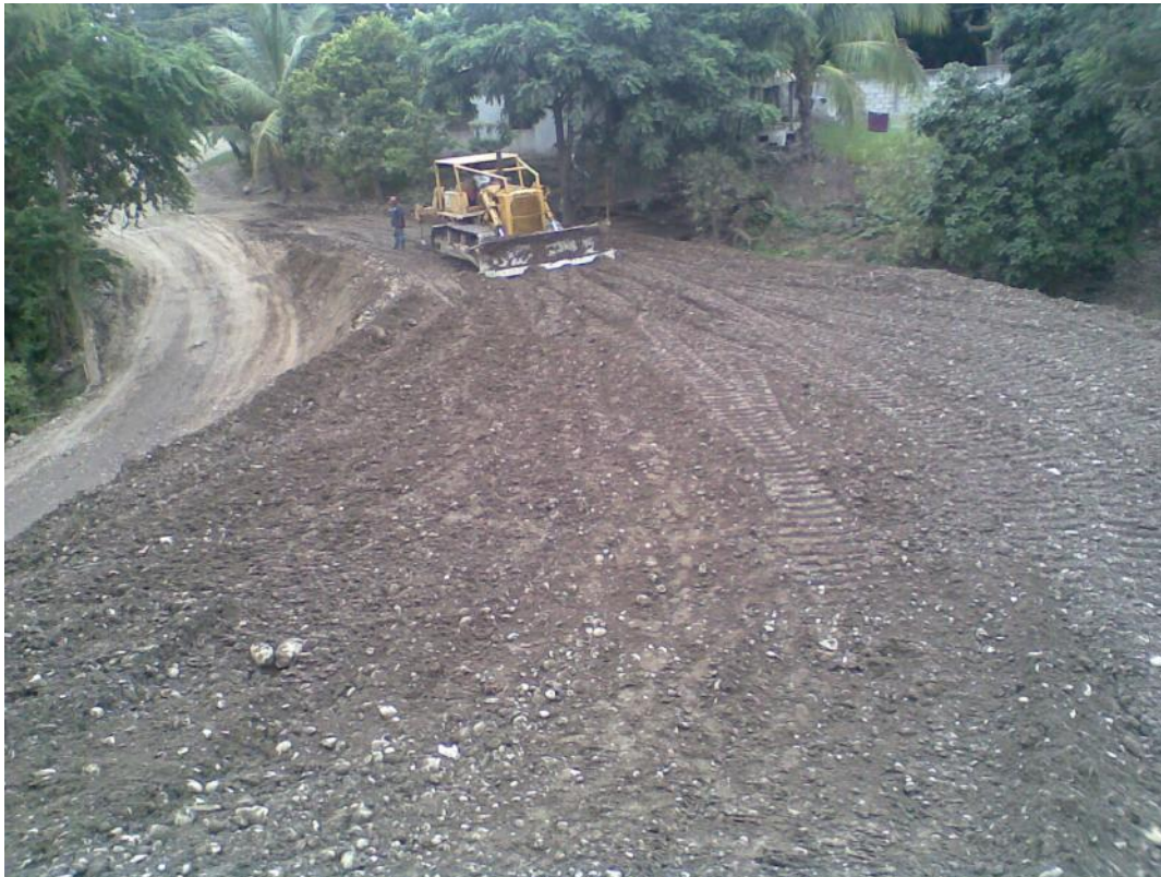
Foto No. 176 Bando de tractor sobre el terraplén.
