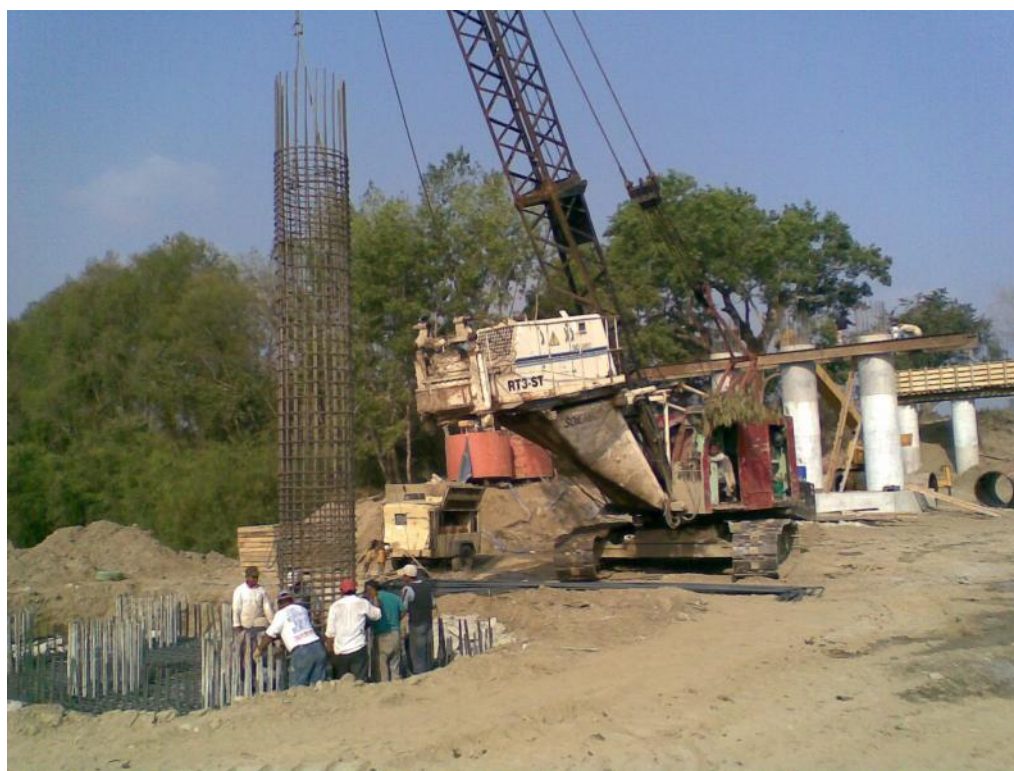
Foto No. 47 Colocación de columnas sobre la parrilla inferior de la zapata con draga para facilitar la colocación de acuerdo a proyecto.
