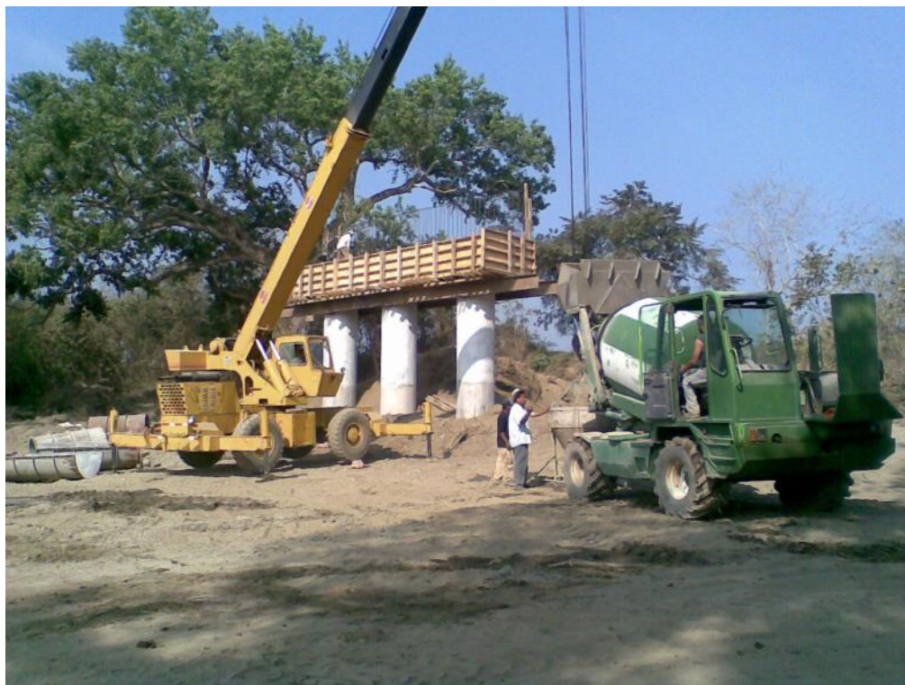
Foto No. 61 Se cimbra y el colado con bacha, y concreto con autohormigoneras.
