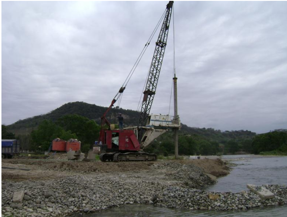
Foto No. 17 En esta imagen se observa los trabajos de perforación para pilotes en el apoyo 4, se puede observar los agitadores de bentonita en la parte trasera, el cual se agregaba de 80 a 110 kg de bentonita por m 3 de agua para estabilizar las paredes.
