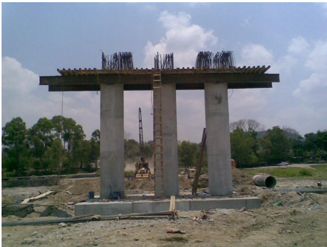
Foto No. 66 Inmediatamente que se cimbra el fondo se procede a colocar los anillo que formaran el armado del cabezal de cuerpo de pila.
