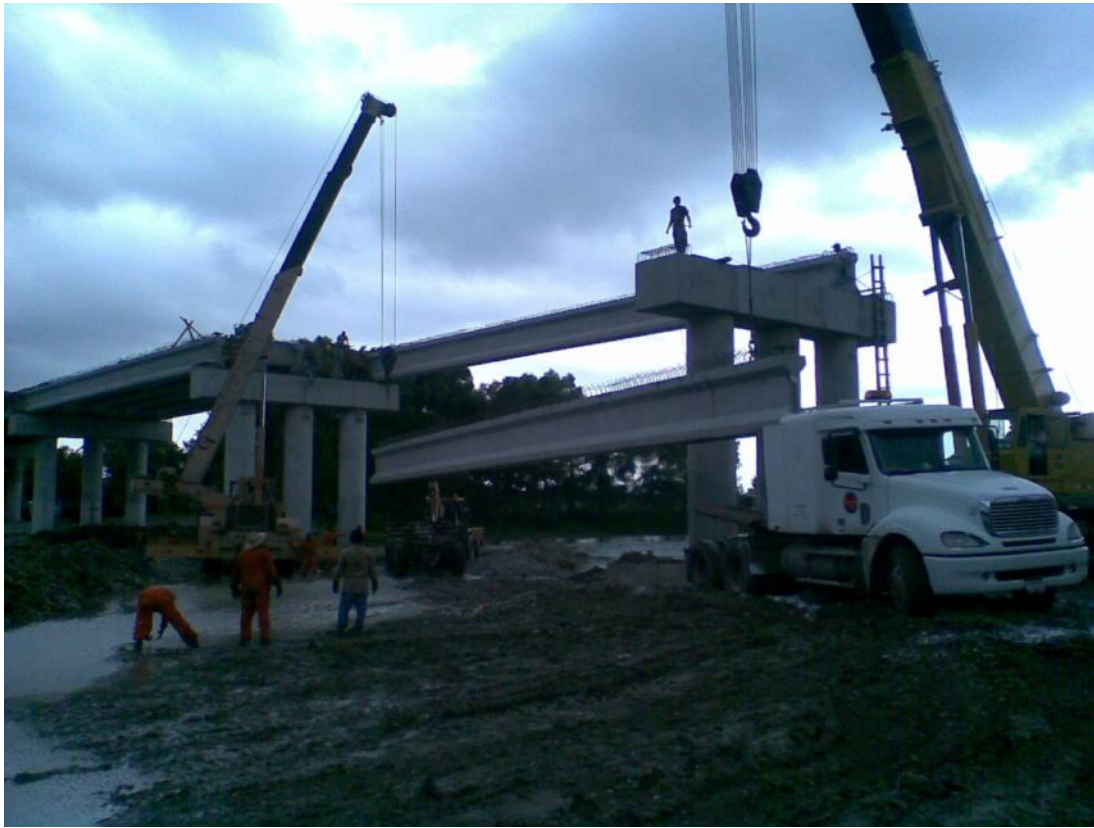
Foto No. 93 Montaje de traves en claro central, con complicaciones por estar muy saturado y con flujo de agua.
