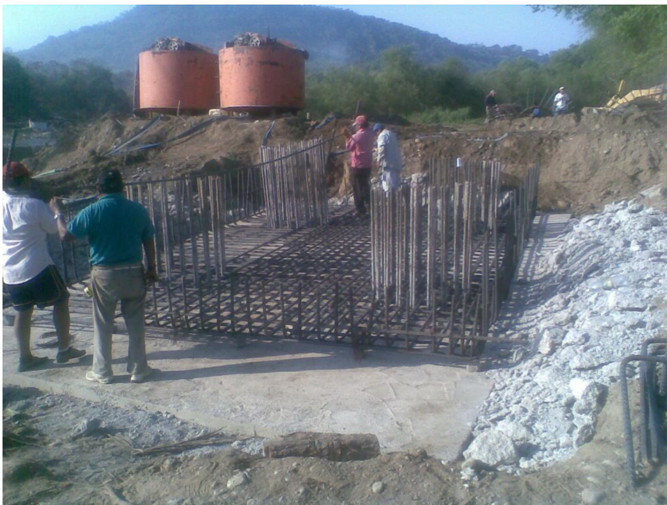
Foto No. 35 Se observa el armado de la parrilla inferior de la zapata del apoyo No. 7, como se podrá ver se le colocaron separadores para cumplir con el recubrimiento.
