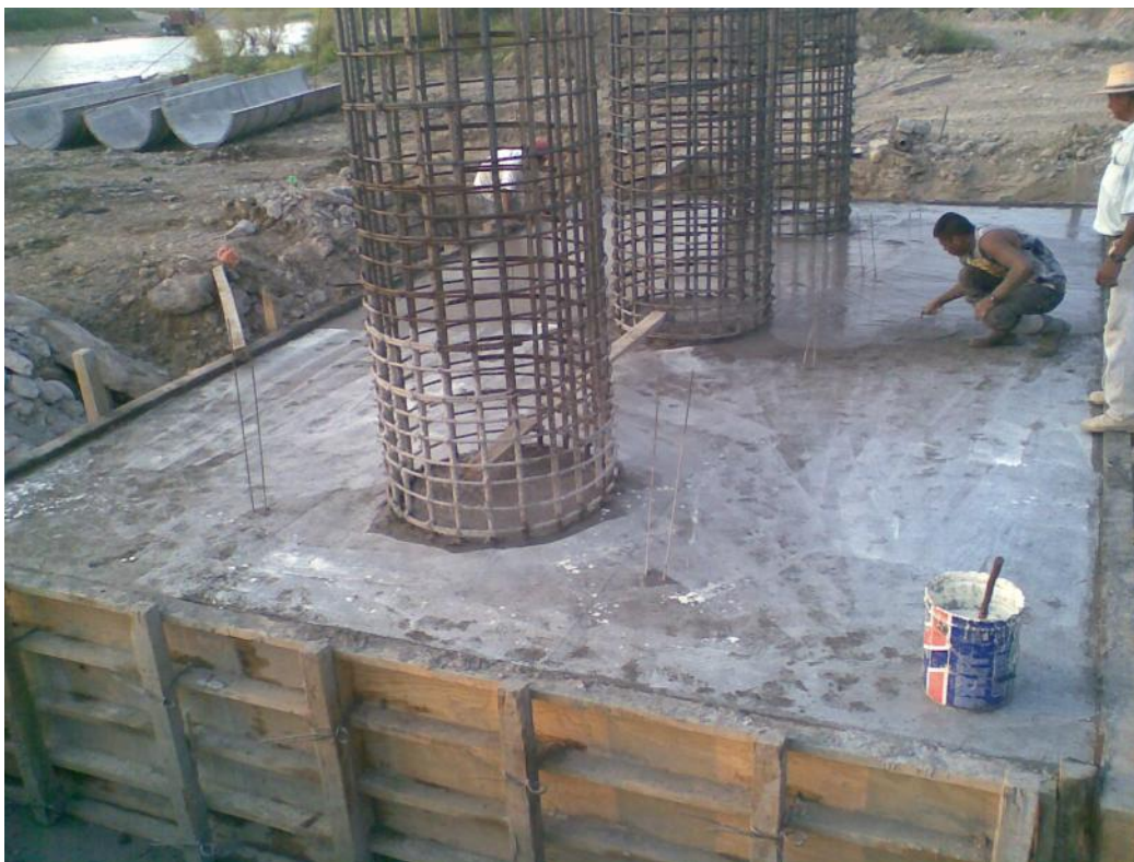
Foto No. 43 Se le da terminado a la zapata y se observa donde ya va fraguando se le va colocando curacreto para evitar perdida de agua.
