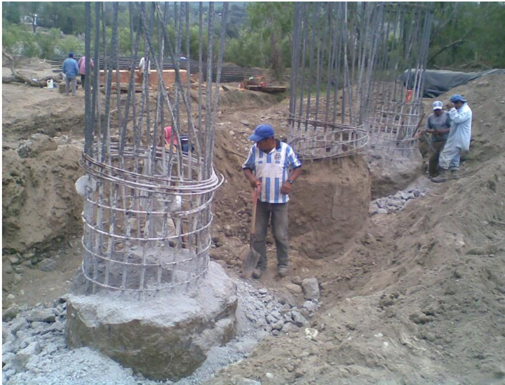
Foto No. 29 Se observa el descabece de pilotes del caballete No. 8, se realizo excavación previa.
