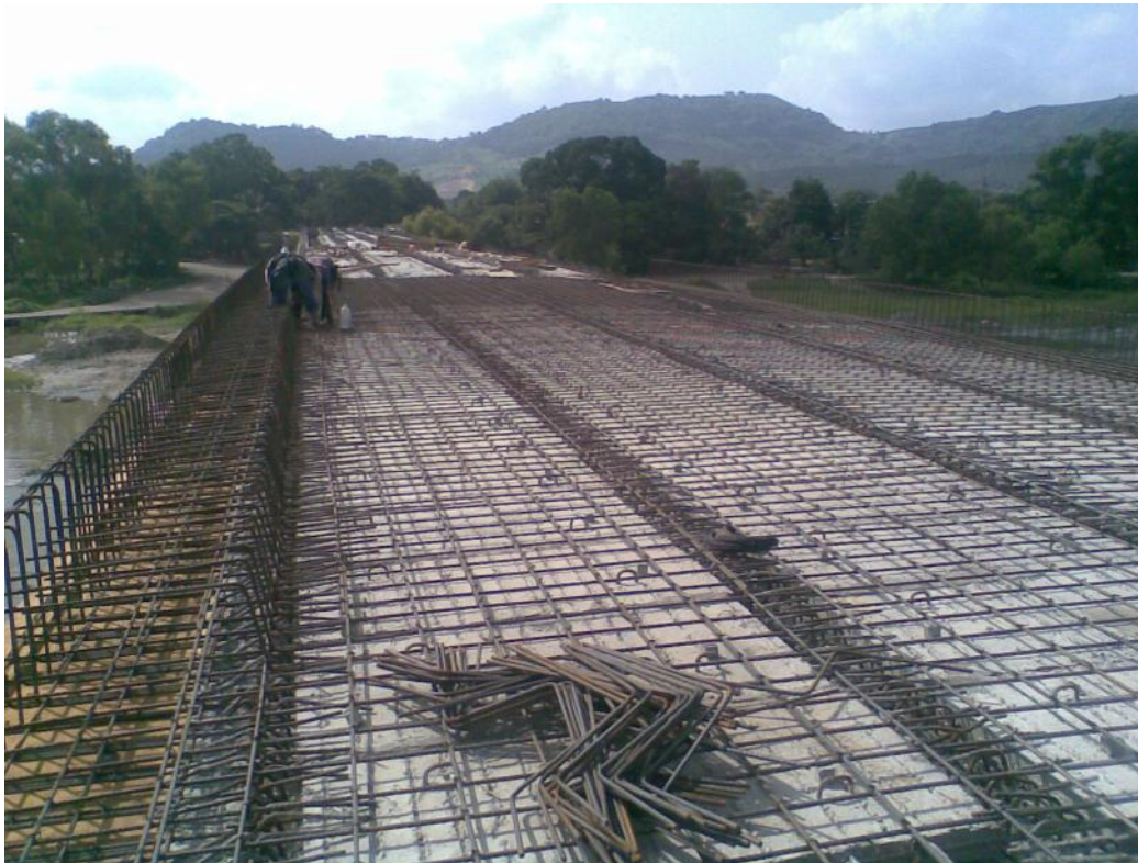
Foto No. 138 Se muestra el armado de banqueta, el cual se alinea con hilo
