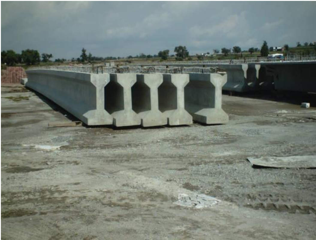
Foto No. 81 Conforme se vayan colado las traves se tapan y se acelera el fraguado con vapor, para que inmediatamente las retiren de la plancha de tensado y estiben para el traslado.
