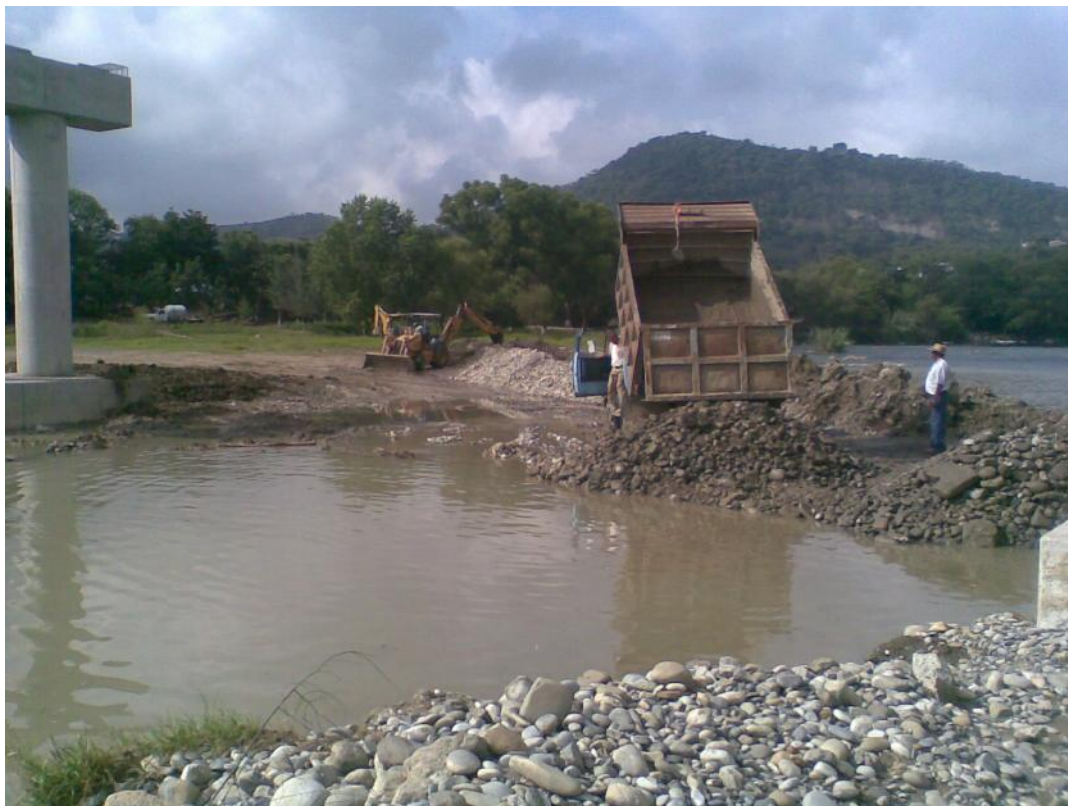
Foto No. 86 Se desvía el cauce a la otra margen y se arma plataforma para la colocación de las traveses.
