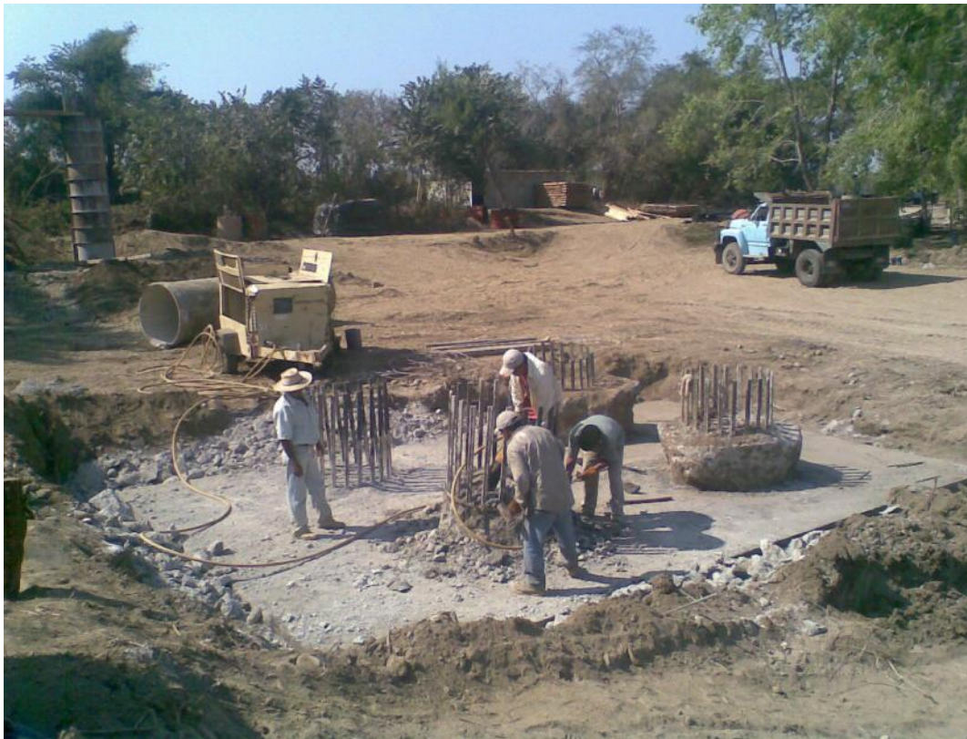
Foto No. 32 Se observa el descabece de pilotes del apoyo No. 7, como se puede ver se ejecuto de acuerdo a proyecto con solo 4 pilotes
