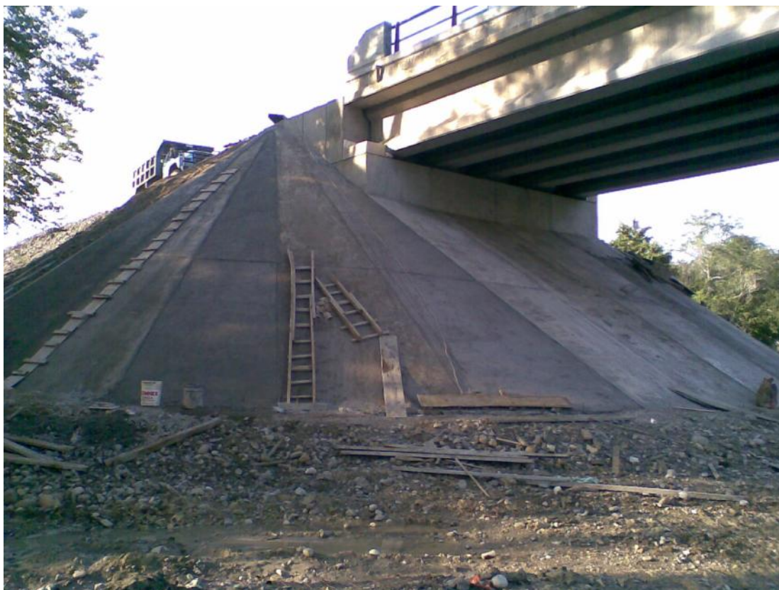
Foto No. 185 Losas en cono de derrame a la esquina del alero.
