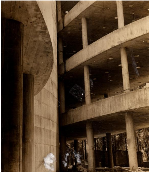
Imagen 37. Vista interior – Construcción de entresijos de la E.S.I.M.E. de la Ciudad Politécnica. Fuente : Imagen digitalizada. Archivo de José Luis Hernández Mendoza
