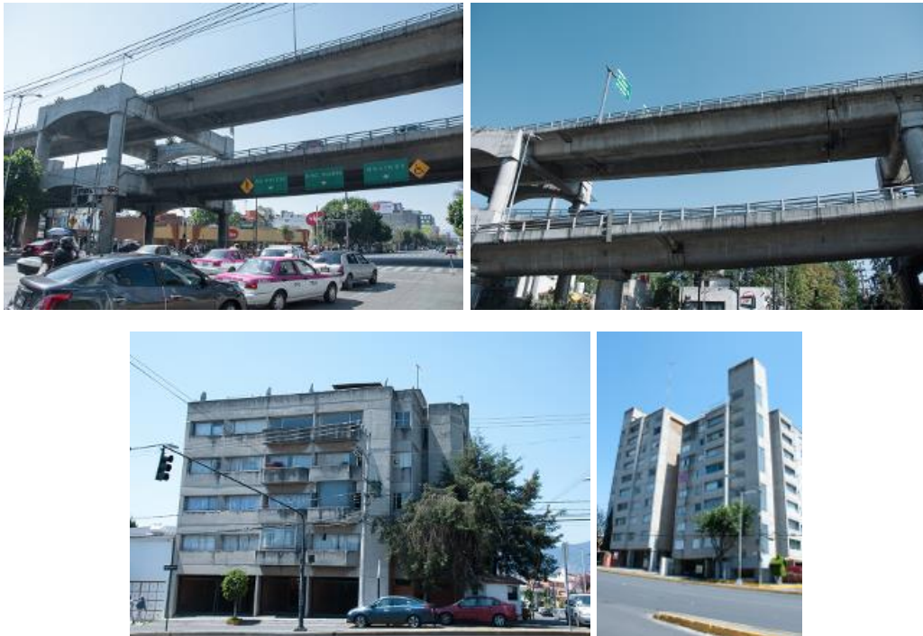
Fig. 4.2 Suciedad presente en fachadas de distribuidores viales y edificaciones ubicadas en la ZMVM.
