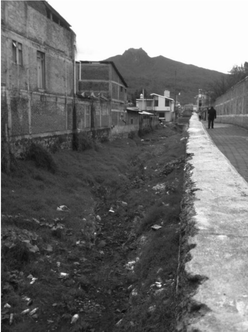
Fotografía 5.2.3 Fuente: Foto tomada en sitio. Se puede apreciar un nivel de deterioro y de contaminación en el arroyo. Diciembre 2013
