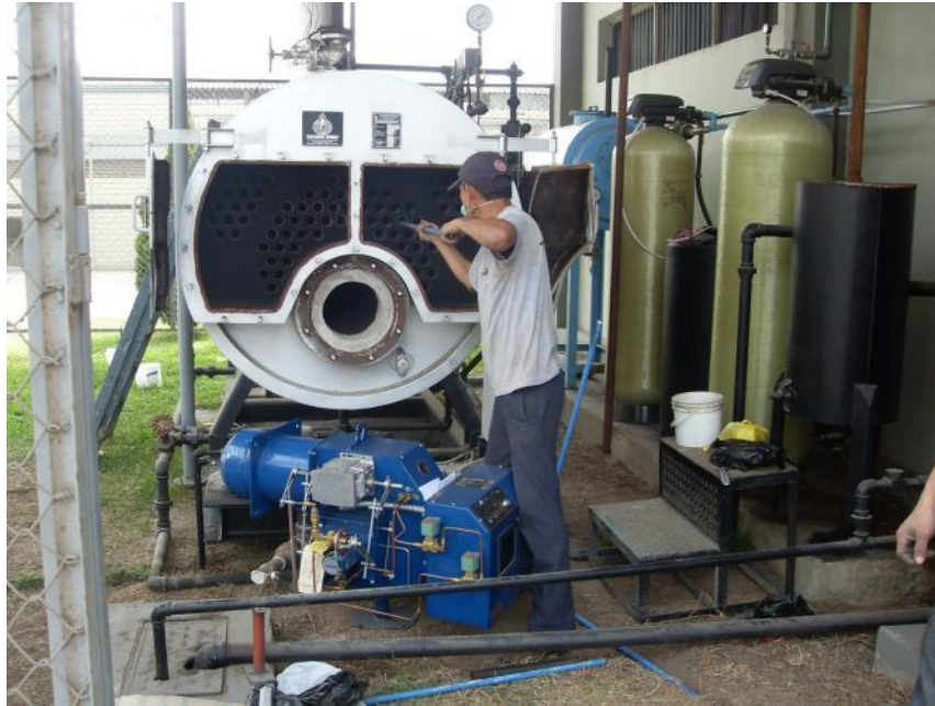
Figura 1.1. Mantenimiento preventivo de una caldera
