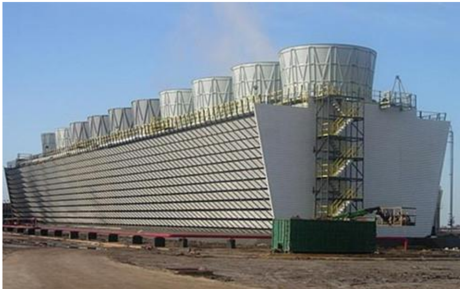
Figura 2.12 Torres de enfriamiento
