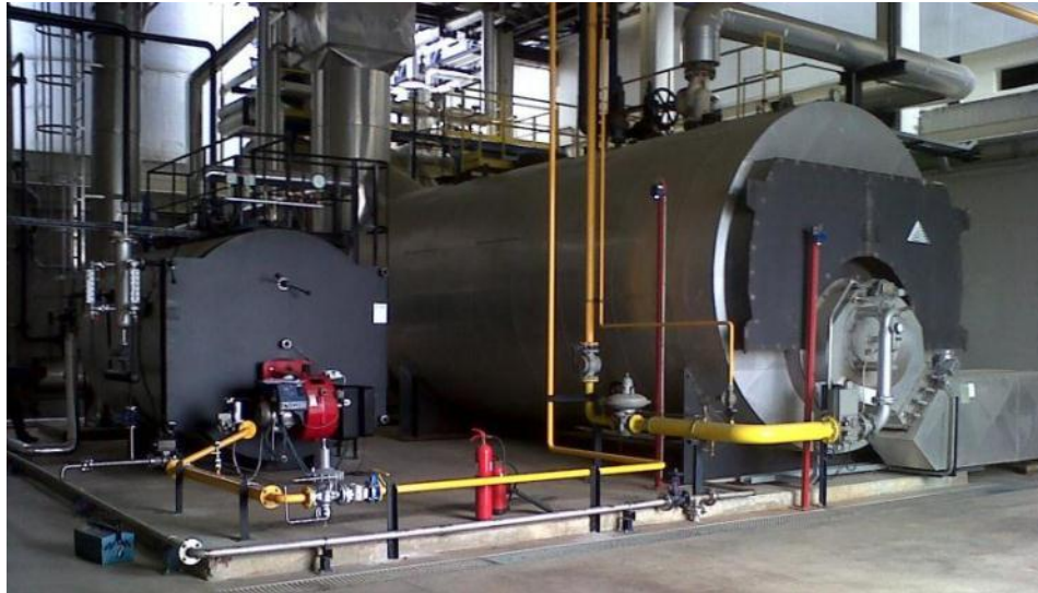
Figura 2.1. Calderas de vapor
