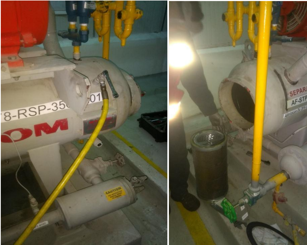
Figura 3.25 Mantenimiento anual a compresores de tornillo
