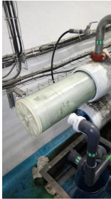
Figura 3.6 Cambio de membranas de la ósmosis inversa
