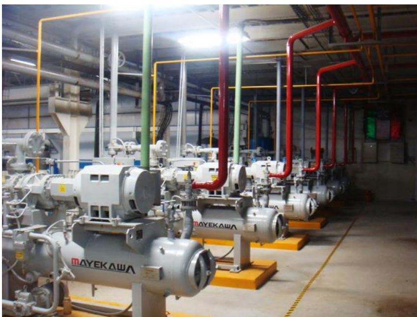
Figura 2.11 Compresores de amoníaco
