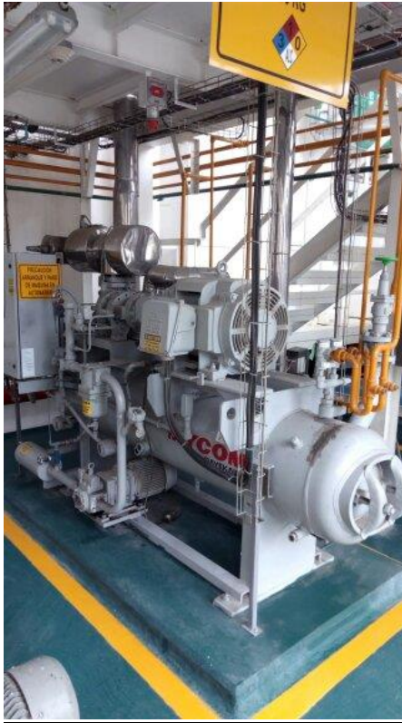
Figura 3.19 Compresor de tornillo Mayekawa 200 tons.
