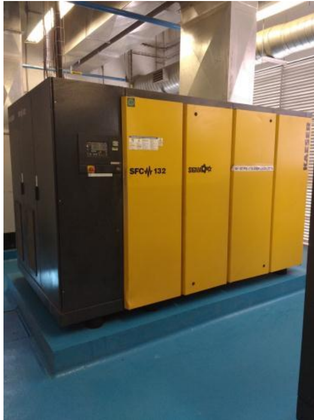
Figura 3.9 Compresor de Aire Kaeser de 200 hp
