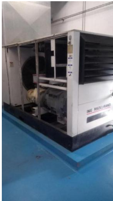
Figura 3.12 Compresor de aire Ing Rsoll Rand de 150 hp
