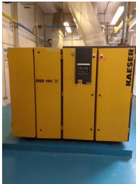
Figura 3.11 Compresor de aire Kaeser de 150 hp
