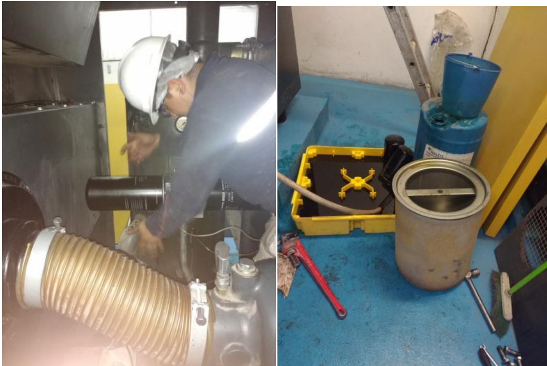
Figura 3.17 Mantenimiento a compresor de aire Kaeser de 200hp
