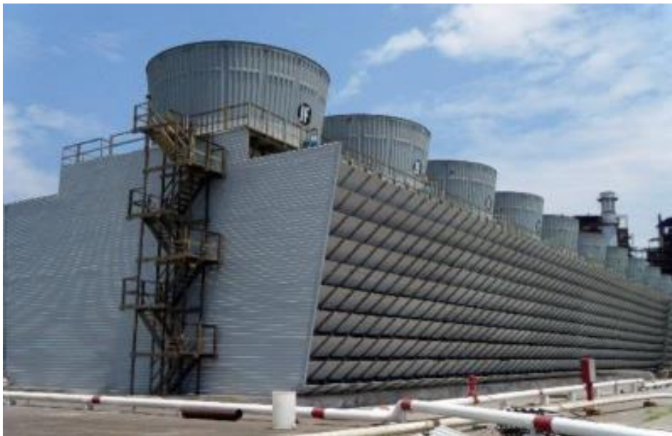
Figura 3.21 Torres de enfriamiento Evapco
