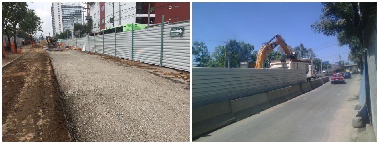
Figura 22 Zona de obra confinada con tapial y barreras de concreto desde CD-03 a PC-04'
