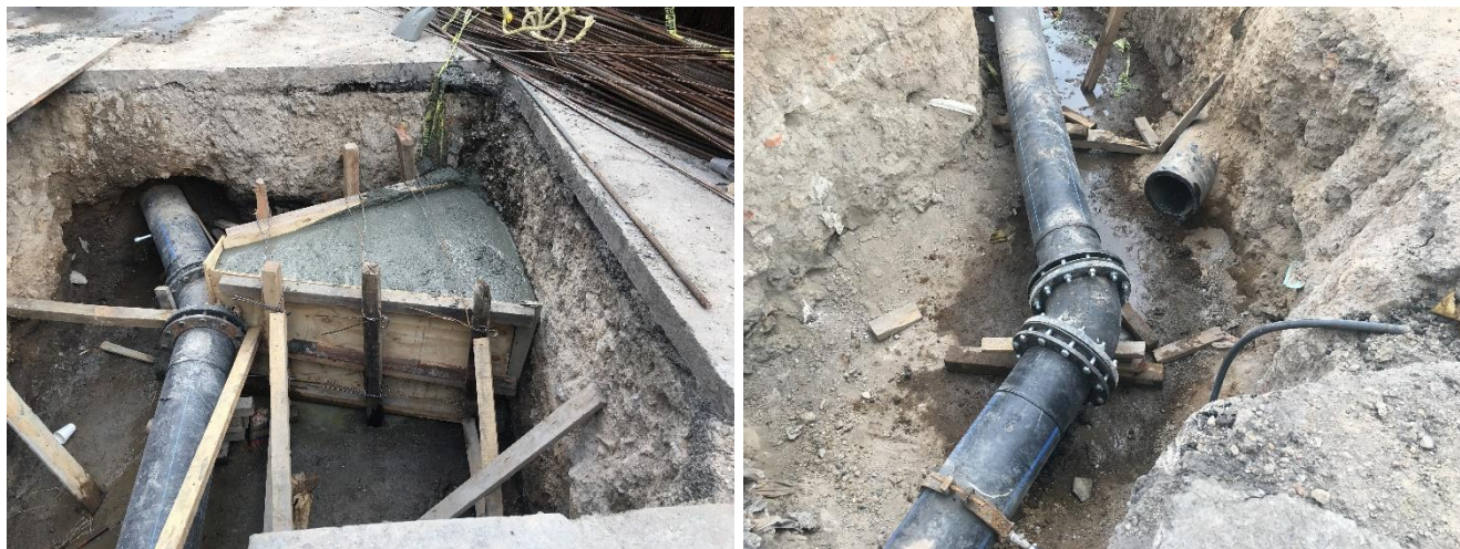
Figura 29 Tubería de agua potable de 12"
