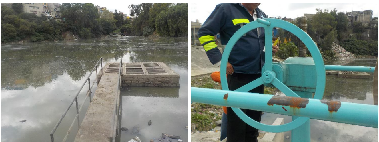
Figura 82 Cierre de compuertas de la presa
