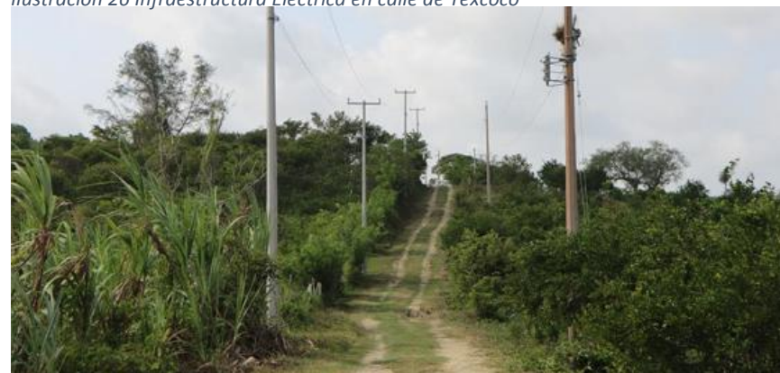
Ilustración 26 Infraestructura Eléctrica en calle de Texcoco
