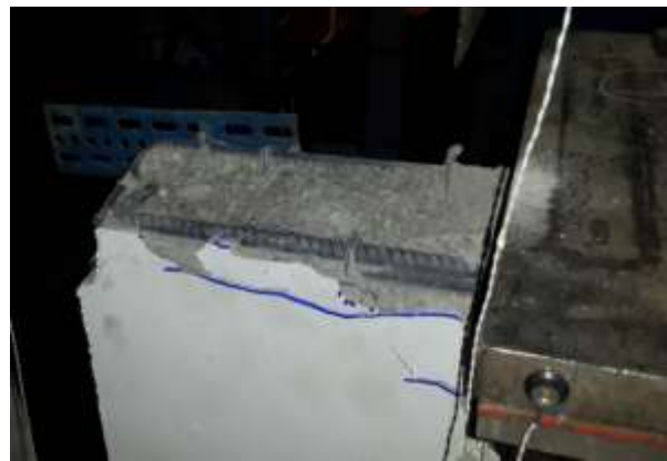
Fig. 2.31 Falla del muro en la conexión del lado izquierdo.
