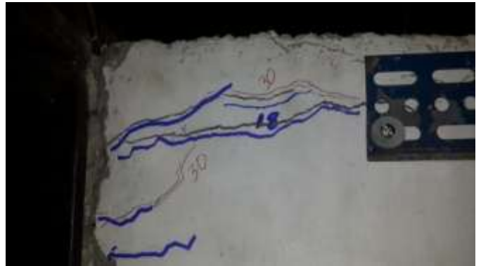
Fig. 2.30 Formación de grietas a diferentes desplazamientos
