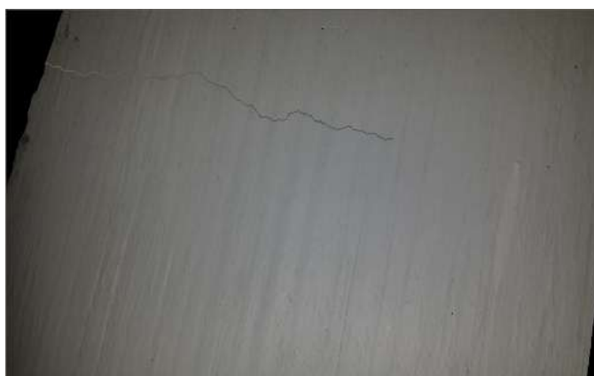
Fig. 2.20 Fisura en la parte media de la columna
