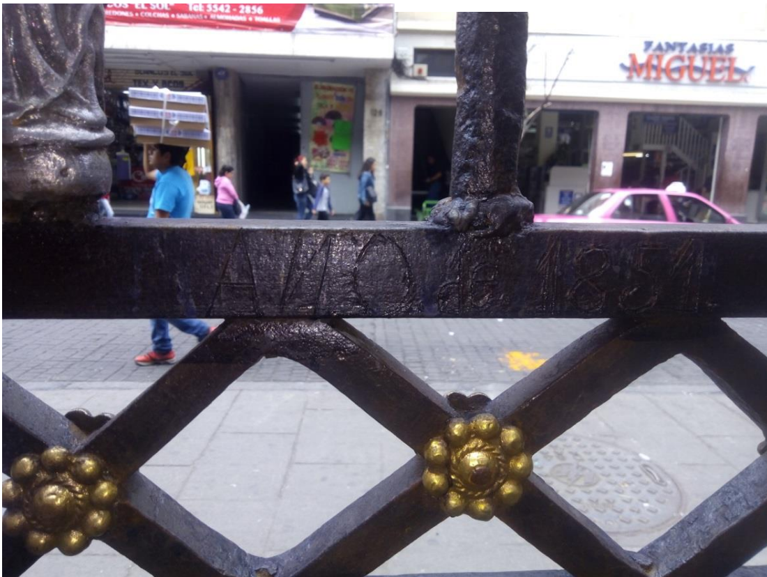
Ilustración 93. Detalle de la reja del atrio del Templo de Balvanera. Fotografía del autor, 2016.
