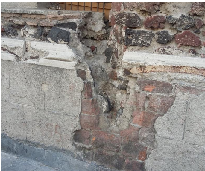
Ilustración 151. Detalle de la fachada oriente del antiguo Convento de Jesús María. Fotografía del autor, 2015.
