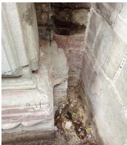
Ilustración 221. Restos de capa pictórica en zócalo de muro de fachada sur del Templo de San Bernardo. Fotografía del autor, 2017.
