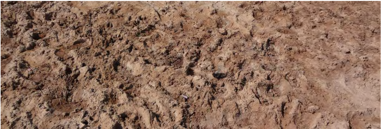
Imagen tomada en el deportivo Valle de Anáhuac, donde puede observarse la compactación del suelo y una capa superficial de salitre.
