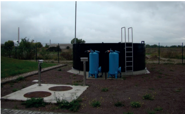
Planta de tratamiento de agua y su remediación.
