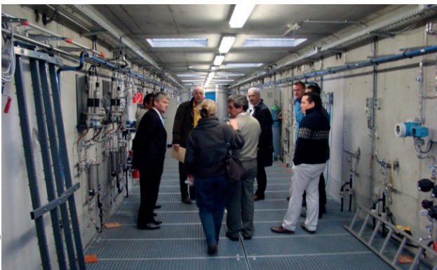
Túnel interior, se encuentra debajo del área de circulación superior y donde se encuentran los domos para capturar luz.
