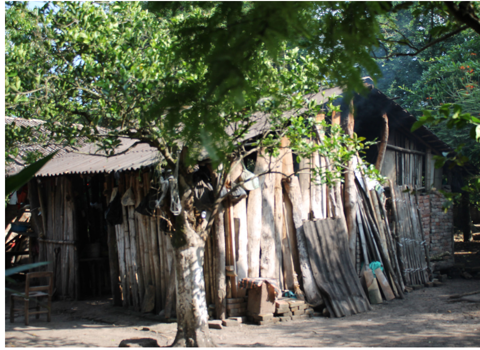
Fotografía 2 Cocina. Muros de carrizo, madera y ladrillo rojo recocido, estructura de madera, techo de lámina tipo teja.
