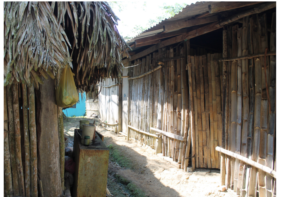
Fotografía 7 Pasillo de cocina y cuartos. Muros de carrizo y bejuco, techo de palma y lámina. Estructura de madera. crédito: Daniel Nahmad Molinari
