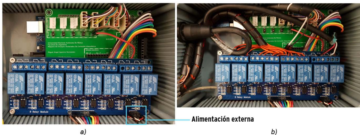
Fig.4.7 a) Relevadores y microcontrolador montados b) Conexiones realizadas de los relevadores a las válvulas de los gases
