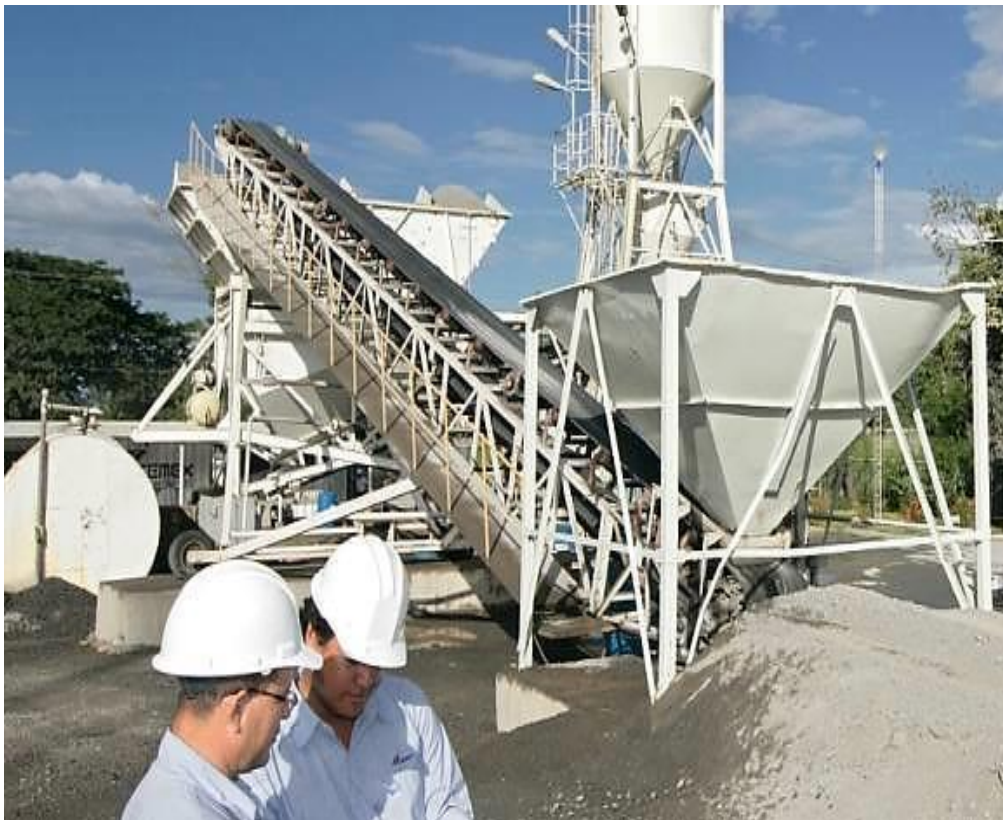
FOTOGRAFIA 5: PLANTA CONCRETERA MECANO.
