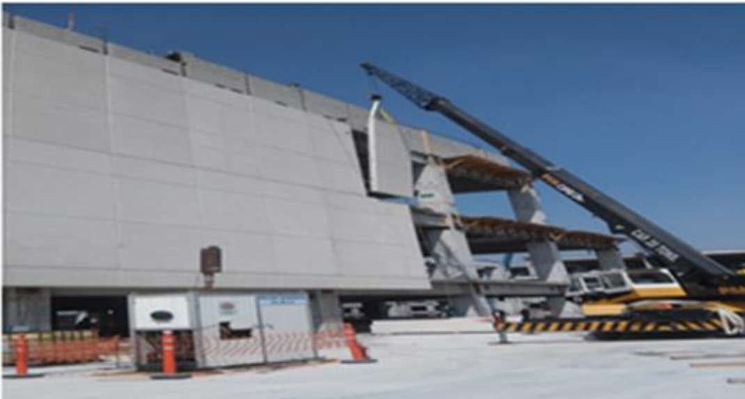
FOTOGRAFIA 3: MONTAJE DE LA RAPIDEZ DE LAS FACHADAS PREFABRICADAS, CENTRO COMERCIAL VIA VALLEJO.
