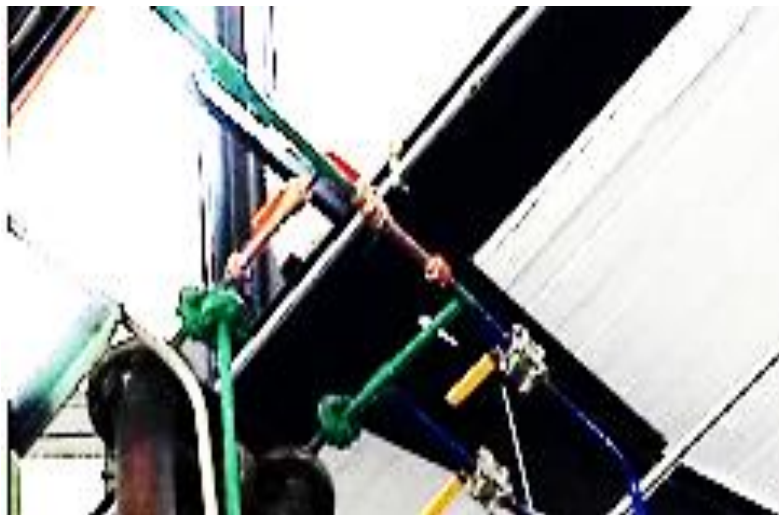
Figura 3.3 Tubería de la línea de agua de enfriamiento.
