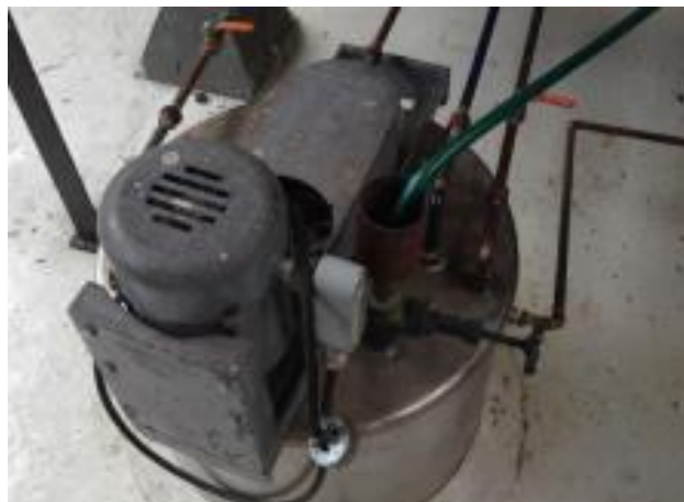
Figura 3.5 Tanque de alimentación TA-001.
