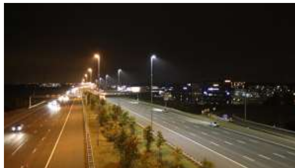
Figura 4.35 Luminarias en el centro con poste cada una de un boulevard.
