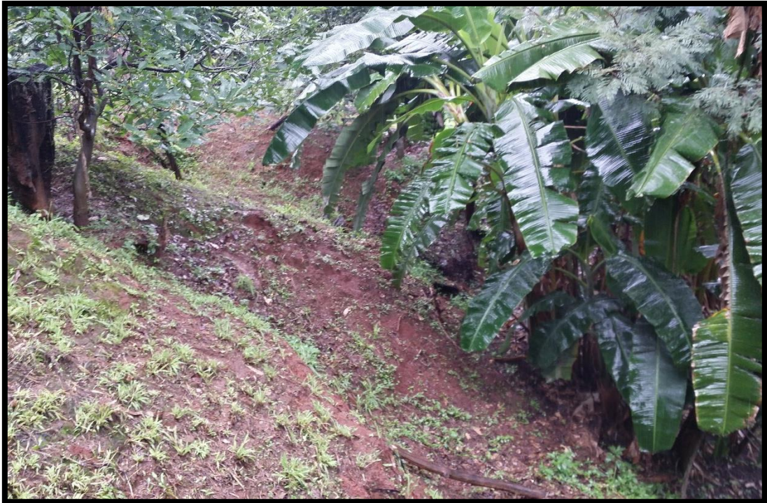
Imagen. 3.5.-Se observa la socavación que ha dejado el paso del agua.
