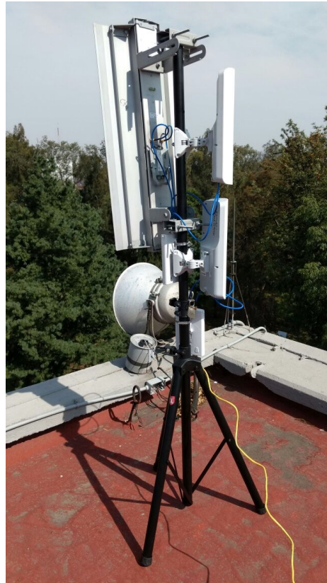
Fig. 6.2 Nodo RSU sobre la azotea del IIMAS
