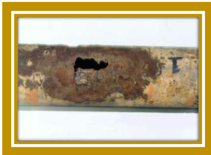
Figura 8.6. Los ambientes dañinos provocados por la mezcla entre fluidos ocasiona el desgaste e incluso la ruptura de tuberías ocasionando mayor pérdida de fluido. Tomada de http://plantaexternatelefonica.blogspot.mx .
