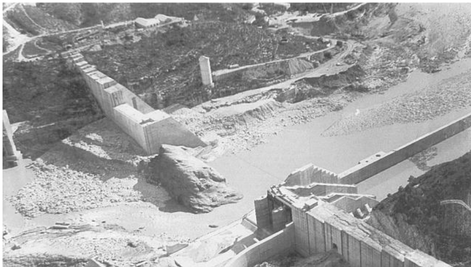
Ilustración 2.9 Presa en España (hormigón). Fallo por negligencia, 1982.
