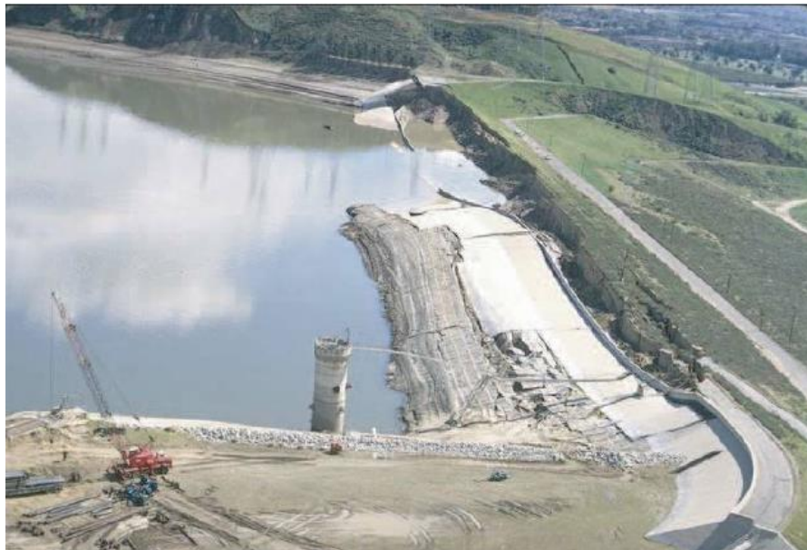
Ilustración 2.7 Falla de una presa en California, en 1971
