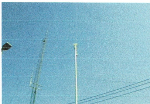
Foto 35. Poste de cámara de vigilancia
