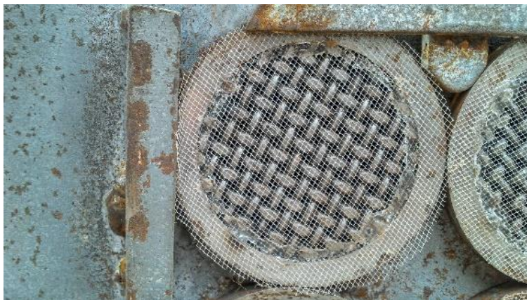
Imagen 8. Corte y soldado de la malla de acero al carbón, acoplada sobre anillos de 6 cm de diámetro del mismo material.
