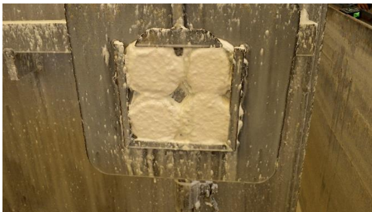
Imagen 9. Se coloca el asbesto en forma de pasta para hornearse sobre los anillos de acero al carbón.
