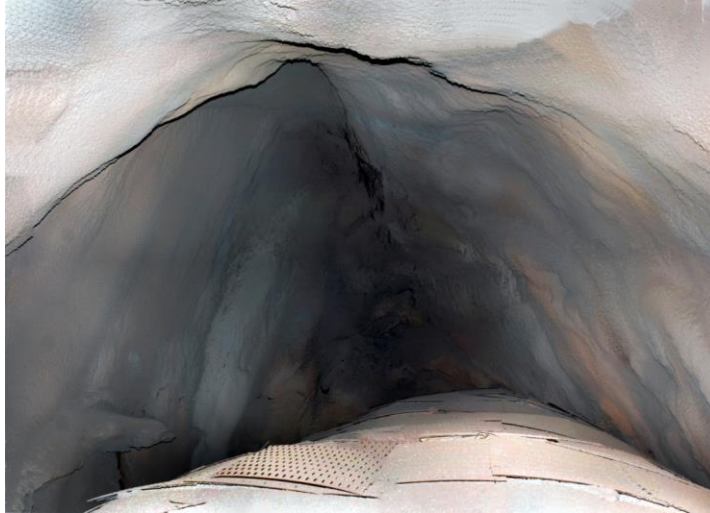
Figura 132. Zona desprendida por aflojamiento en la clave. Túnel Interlomas I. Estado de México, julio de 2014 (Consultec, 2014).
