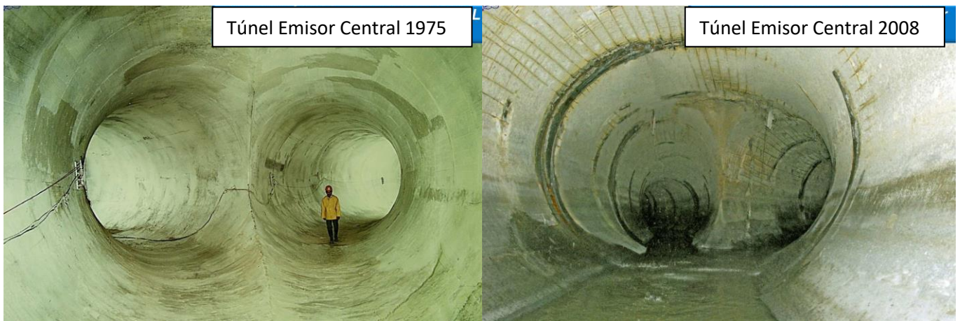
Fig. 7. Confluencia del Interceptor Oriente y Central con el Túnel Emisor Central. A la izquierda se muestra una fotografía de 1975 previo a su inauguración y a la derecha una fotografía que se tomó durante los trabajos de mantenimiento mayor (Moreno, 2014). En la parte baja, se muestra el daño ocasionado por el contacto con las aguas negras; en la sección superior y clave, se observan los daños producidos por los vapores de dichas aguas negras.
