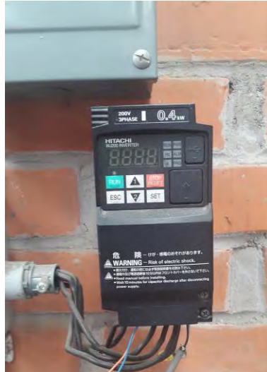
Figura 53. Variador de frecuencia controlado por el Hp Vee
