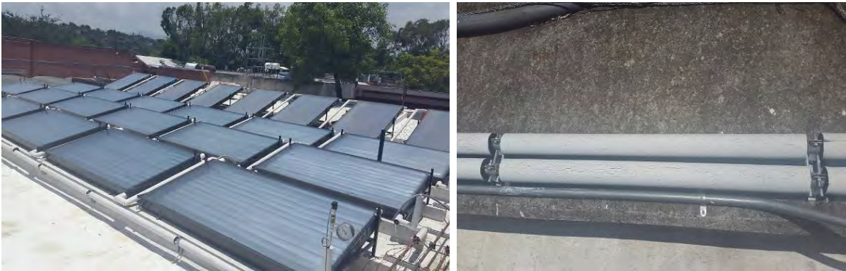
Figura 57. Arreglo de captadores de concentración CPC ( 39.6 \text{ m}^2 ) y tubería con aislamiento en sistema de refrigeración solar con concentradores CPC del IER.
