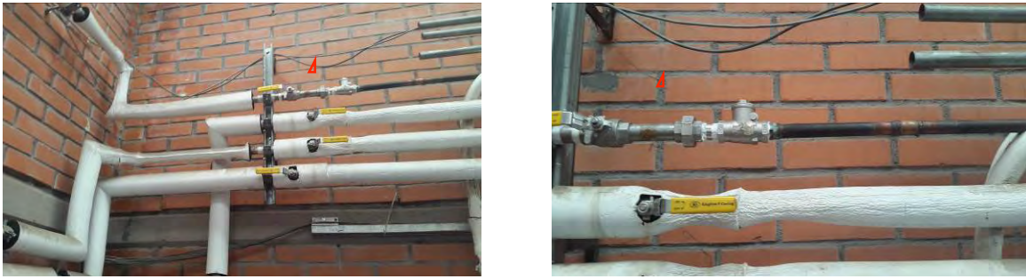
Figura 55. Válvula check instalada para evitar pérdidas nocturnas
