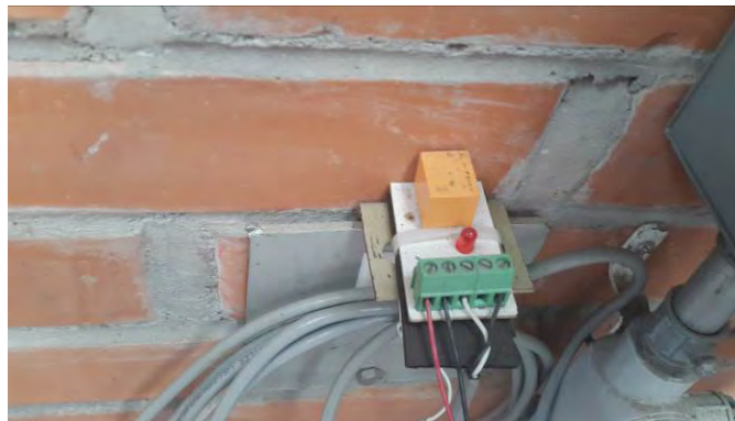
Figura 54. Relevador para arrancar y parar la bomba
