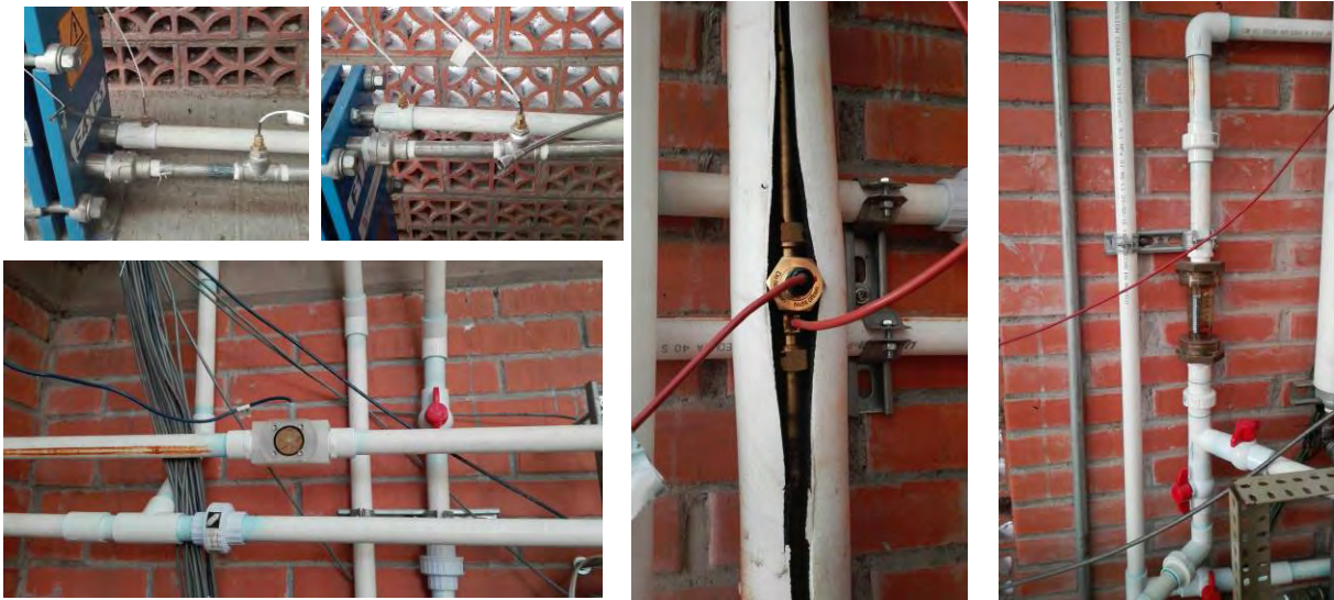
Figura 51. Instrumentación en el intercambiador de calor
