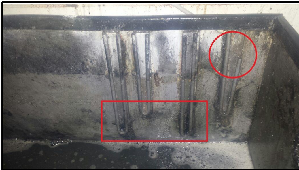
Figura 4.32 Guía fracturada y moho acumulado
