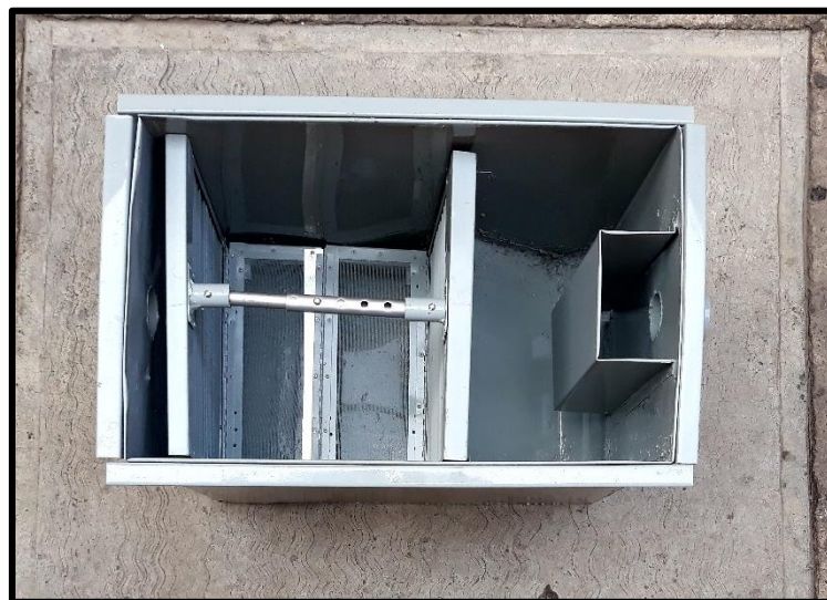
Figura 4.45 Vista superior del mecanismo resultante, al interior de la trampa de grasa
