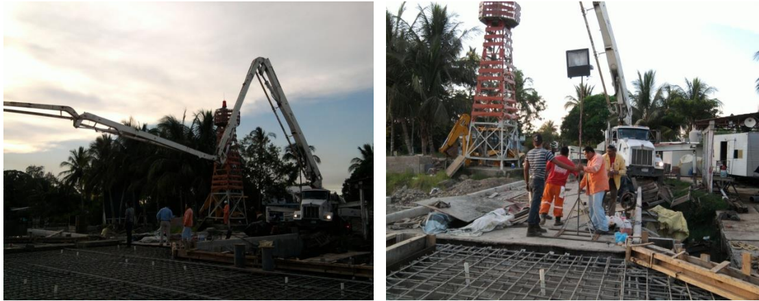
Imagen No.126.- Bomba estacionaria con pluma telescópica, para la colocación del concreto en la trabe T-4, guarniciones y losa del muelle.
