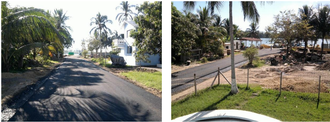
Imagen No.176.-aplicación del riego de sello de mortero asfáltico sobre la carpeta aplicada con la petrolizadora sobre la base del camino de acceso al muelle.
