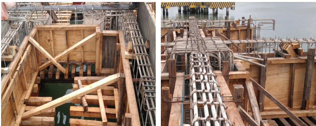
Imagen No.106.- Colocación de tapón a base de polines y barrotes en traveses de los ejes 13, 12, 11 y 7 entre los ejes D a G, tramos pendientes para armar y colar monóticamente con la trabe (T-4) pantalla.
