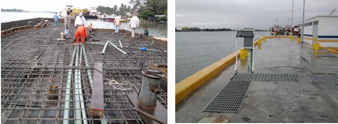
Imagen No.183.- Trabajos previos para las instalaciones eléctricas e hidráulicas, ahogadas en la plataforma del muelle.
