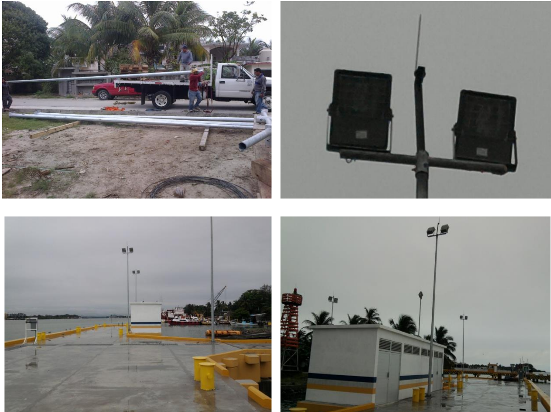
Imagen No.151.- Instalación de cinco postes, con puntas Faraday (pararrayos) y diez lámparas de 400 watts de vapor de sodio de alta presión, en muelle del buque.
