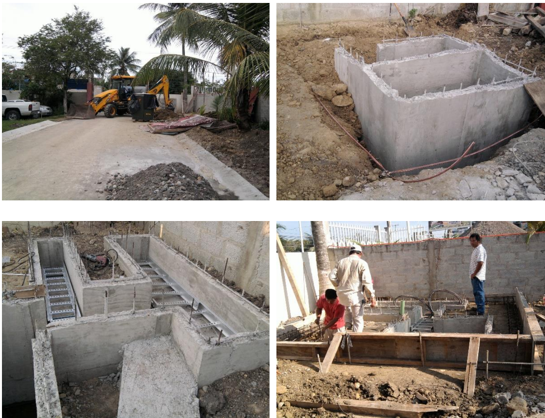
Imagen No.184.- Construcción de dalas de desplantes y trincheras para la caseta de la subestación eléctrica.
