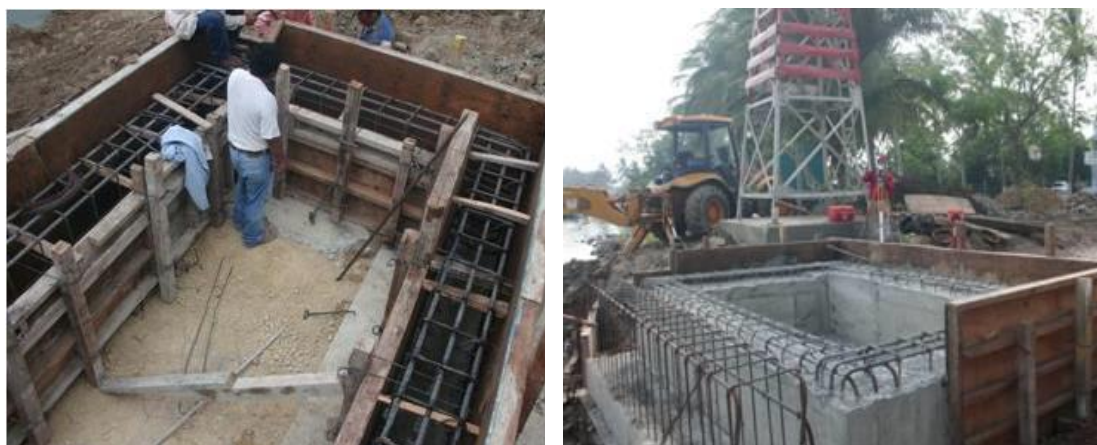
Imagen No.63.- Acero de refuerzo, cimbra y concreto en las traves de la rampa de acceso al muelle.
