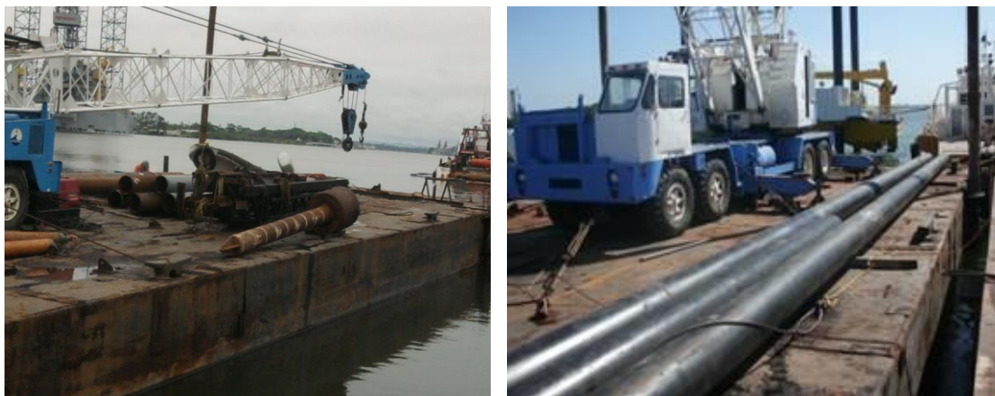
Imagen No.44.- Chalán (balsa) con grúa para montaje de pilotes y traslado de equipos y materiales del almacén a la obra.
