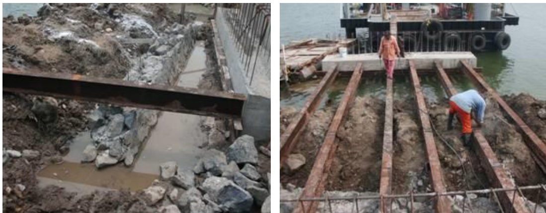
Imagen No.70.- Construcción del muro de contención y obra falsa a base de viguetas, para la construcción de la pasarela acceso al muelle.
