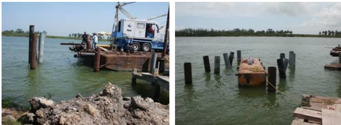
Imagen No.96.- Hincado de pilotes en los ejes 13 y 12 entre los ejes D a G.
