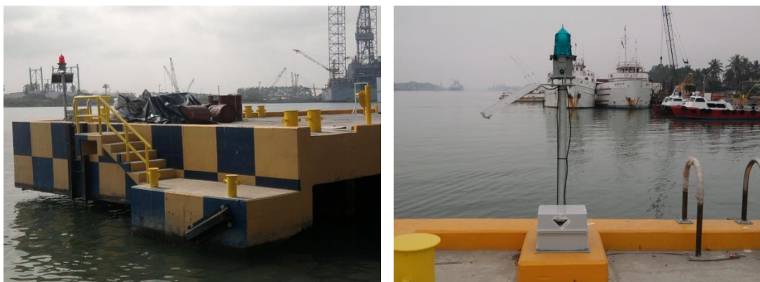
Imagen No.152.- Instalación de balizas con linterna marina roja (babor) y verde (estribor) en muelle del buque.
