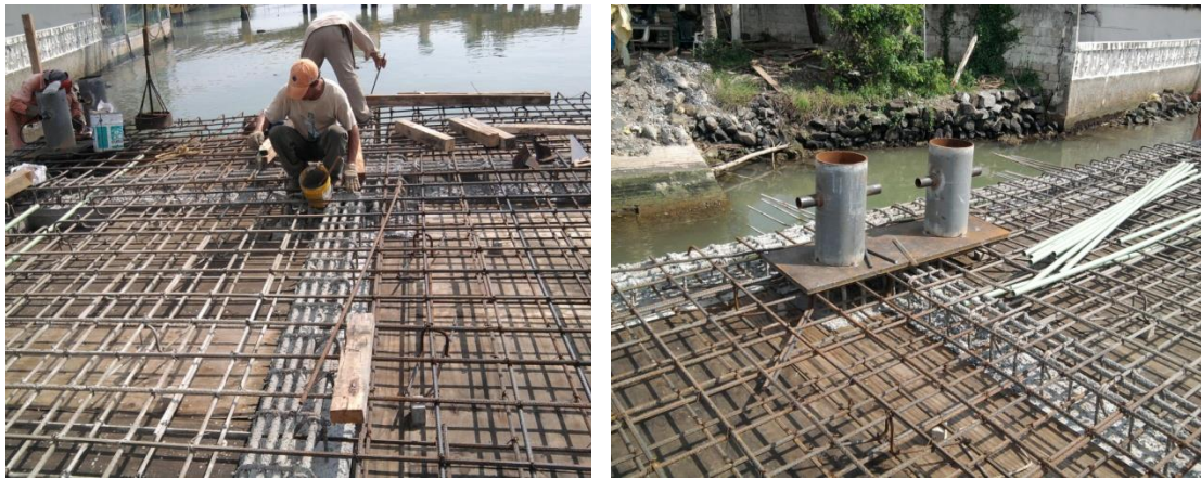
Imagen No.119.- Acero de refuerzo para el armado de la losa y fijación de las bitas de amarre en la losa del muelle.
