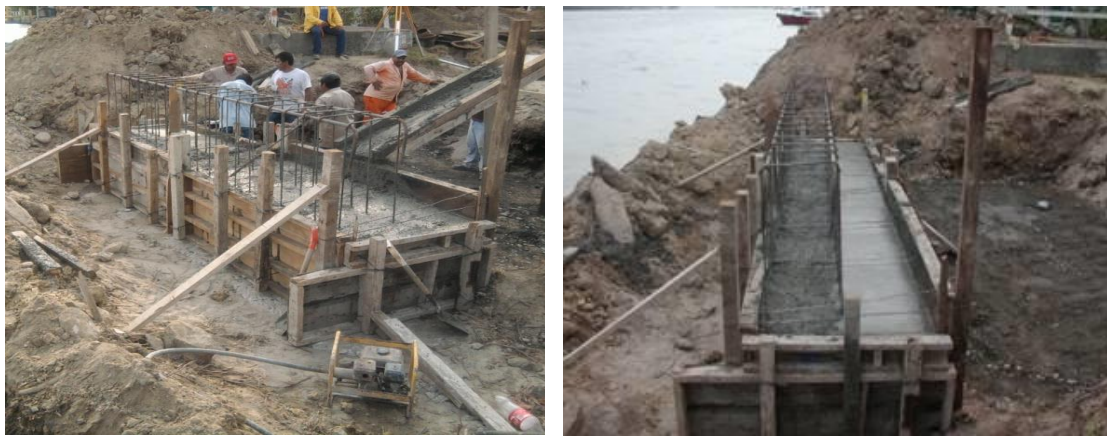
Imagen No.57.-Cimbra, acero y concreto para la construcción de la zapata de la trabe T-10.
