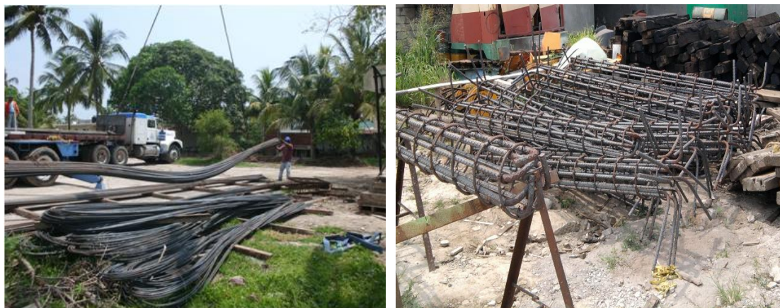
Imagen No.47.- Suministro, habilitado y armado de acero de refuerzo de pilotes en la obra.
