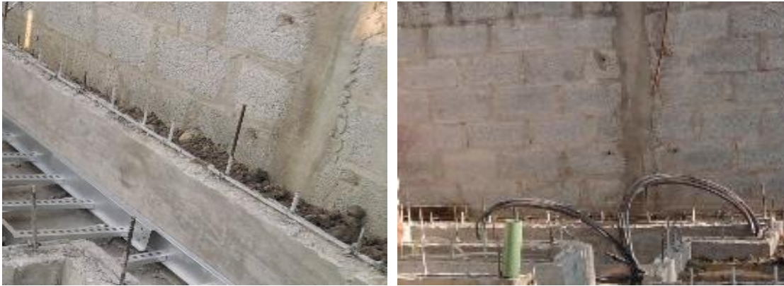
Imagen No.185.- Castillos y muros de block hueco de concreto de la caseta de la subestaci3n el3ctrica.
