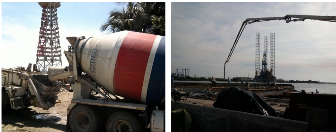
Imagen No.127.- Colocación del concreto en la trabe T-4, guarniciones y losa del muelle, del eje 1 al 7 entre G a D.
