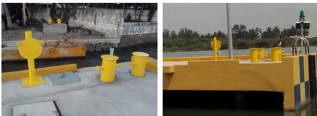
Imagen No.150.- Instalación de tres soportes para salvavidas anular en muelle del buque.
