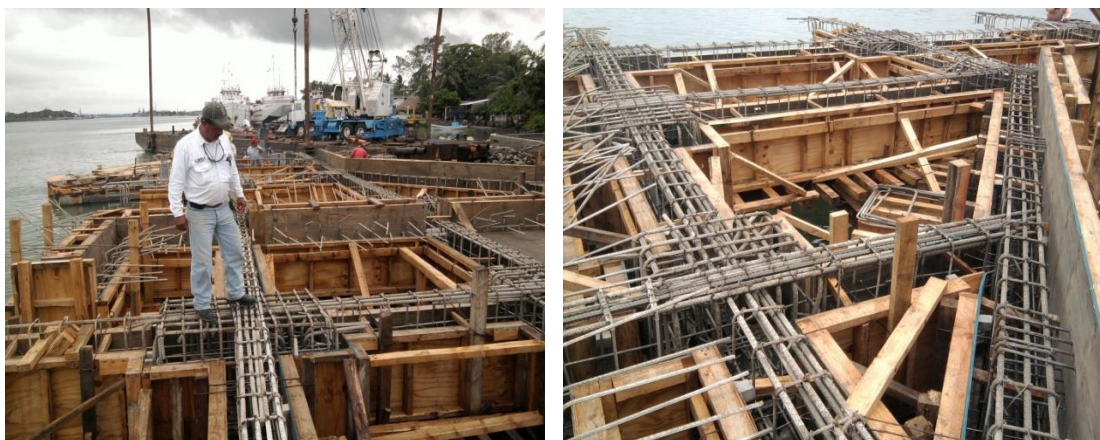
Imagen No.115.- Cimbra de madera y armados con acero de refuerzo en los pilotes, cabezales y trabes entre los ejes del 6 al 1 y del D a G, del muelle.
