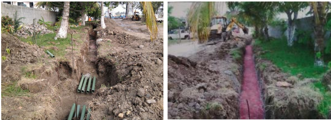
Imagen No.190.- Relleno compactado de arena y colocación de firme de 10 cm sobre las canalizaciones de las tuberías de PVC, para la acometida de la subestación eléctrica al muelle.
