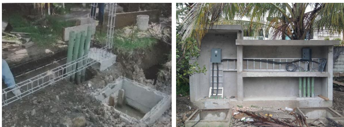
Imagen No.192.- Colocación de registro prefabricados y construcción de nicho para el control de la iluminación del muelle.
