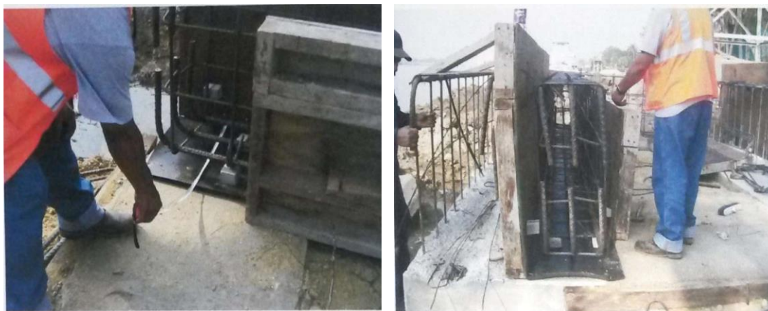
Imagen No.62.-Colocacion de junta de neopreno de 12.7 mm (1/2") de espesor entre las traves de la rampa de acceso al muelle y la trabe T-10.
