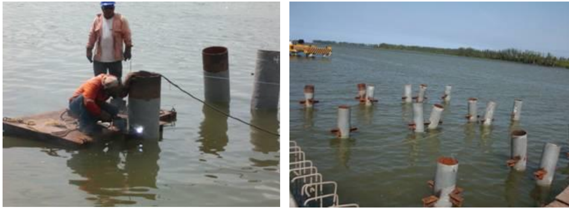
Imagen No.98.- Colocación y soldado de ménsulas en los pilotes, a base de tramos de viguetas IPR tipo I de 6"x4" para la obra falsa.
