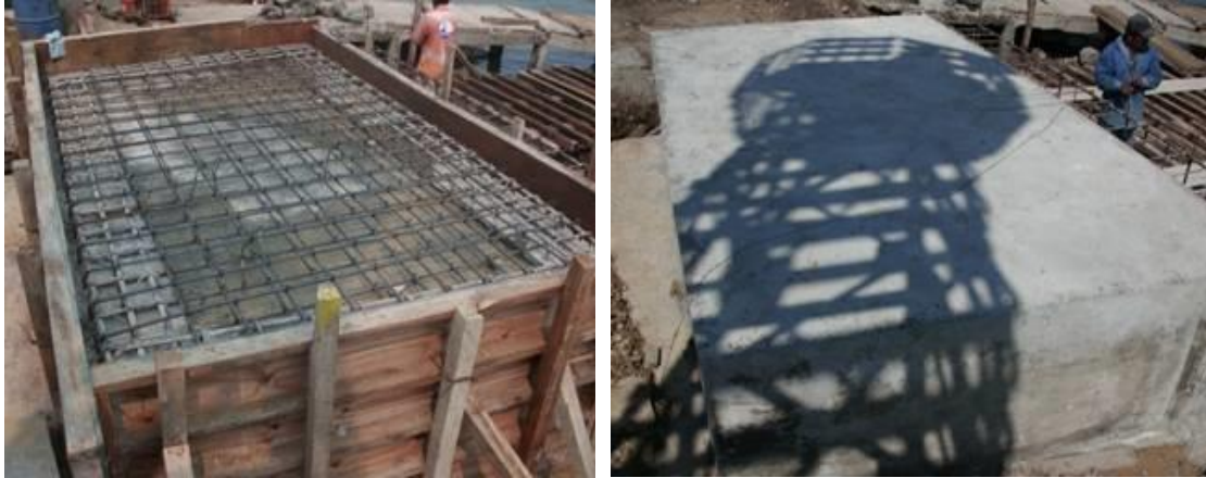
Imagen No.64.- Relleno de tepetate compactado, acero de refuerzo y concreto para losa de la rampa de concreto, acceso al muelle.
