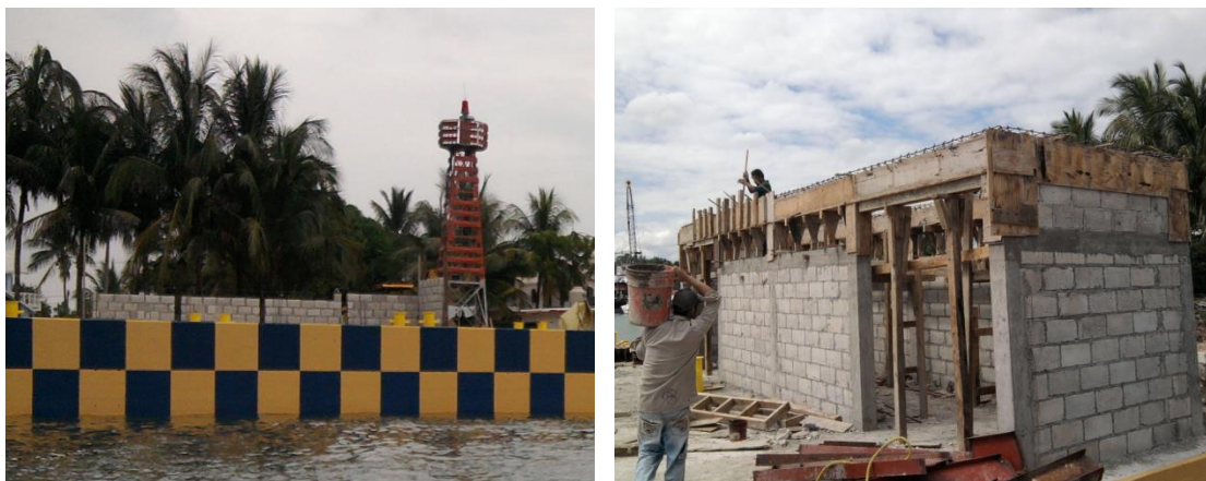
Imagen No.139.- Construcción de la caseta de sistema contra incendios, con muros de block de concreto, castillos, dala perimetral y trabe.
