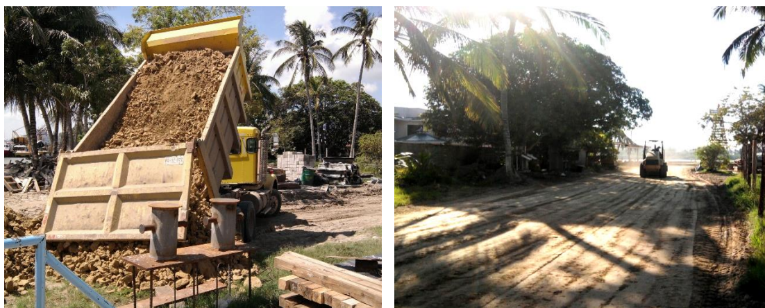
Imagen No.37.- Suministro, colocación y compactación de tepetate que forman el mejoramiento del camino de acceso al muelle.
