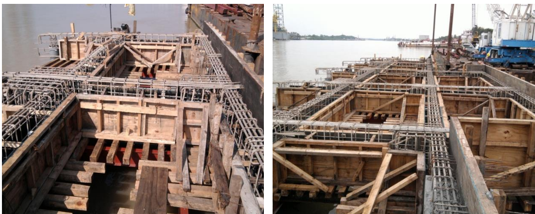
Imagen No.114.- Cimbra de madera y Armados de acero de refuerzo en pilotes, cabezales y traveses en los ejes 3, 2, y 1 entre D a G.
