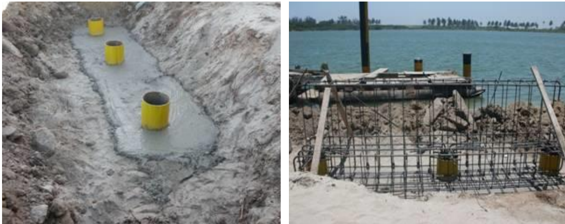
Imagen No.55.- Hincado de los tres pilotes, plantilla y acero de refuerzo en pilotes y trabe T-10.
