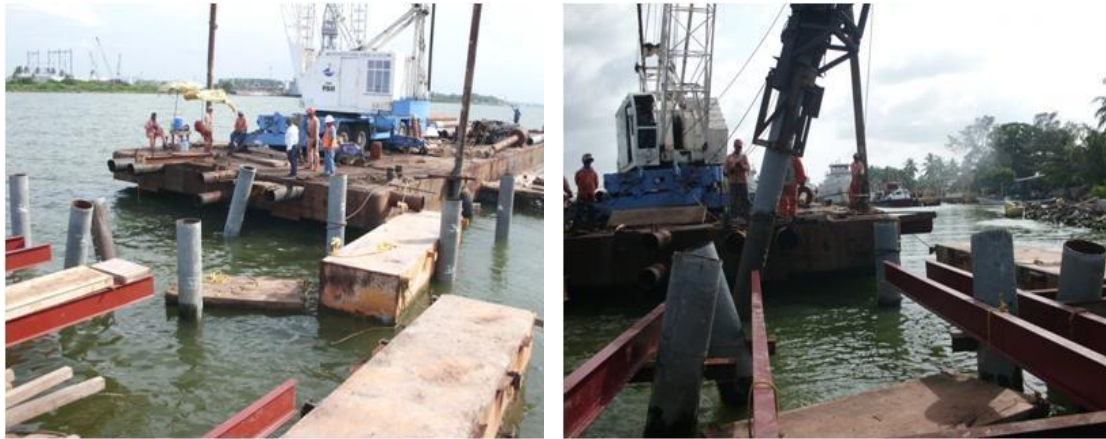
Imagen No.103.- Hincado de los pilotes verticales (PV) e inclinados (PI), de los ejes 6, 5 y 4 entre los ejes D a G.
