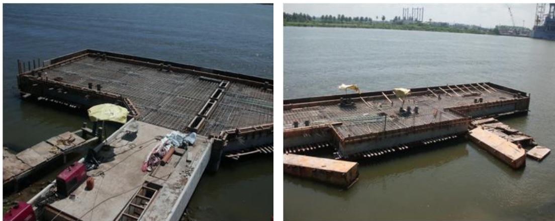
Imagen No.125.- Superficies limpias y preparadas para colar la losa, guarniciones y trabe T-4 (pantalla de atraque) del muelle.
