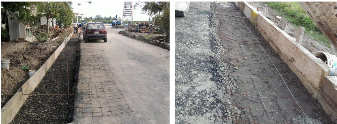
Imagen No.178.-Cama de arena humedecida compactada y cimbra de madera en fronteras de las cunetas del Camino de Acceso al Muelle.
