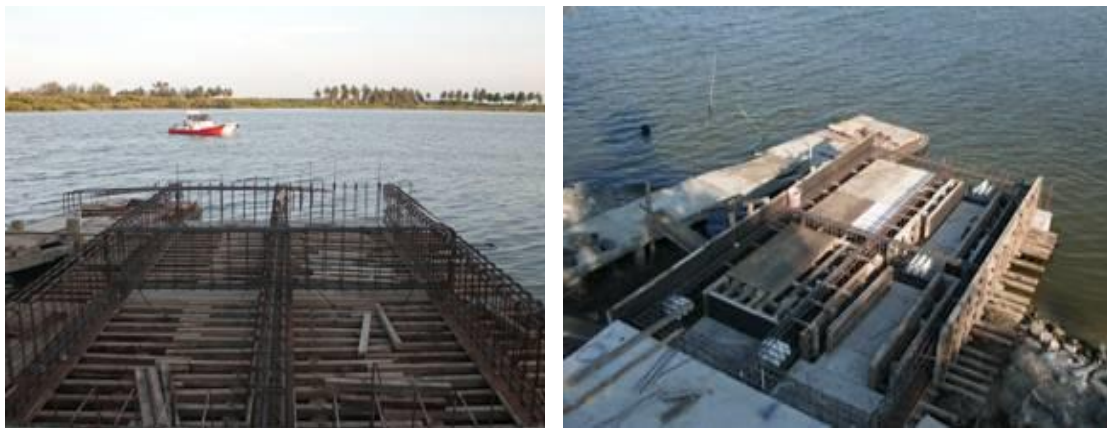
Imagen No.79.- Colocación de acero de refuerzo, cimbra de madera para las traves, trincheras y losa, en la construcción de la pasarela de acceso al muelle en río.
