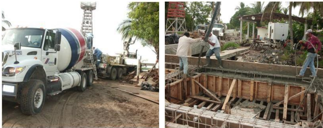
Imagen No.107.- Suministro y colocación de concreto premezclado en cabezales y traveses, entre los ejes 13, 12, 11, y 7 del eje D a G, del muelle en el río.
