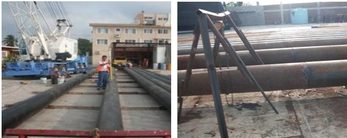
Imagen No.40.- Alineado y Atiesado para la aplicación de soldadura en pilotes
