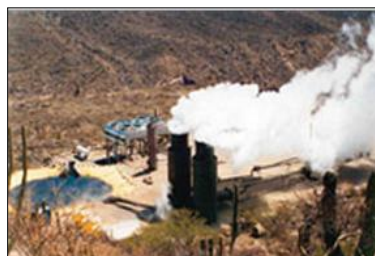
FIGURA 2.16 Central Geotérmica Las Tres Vírgenes (Fuente: Proyecto IMPULSA IV, Instituto de Ingeniería, UNAM).
