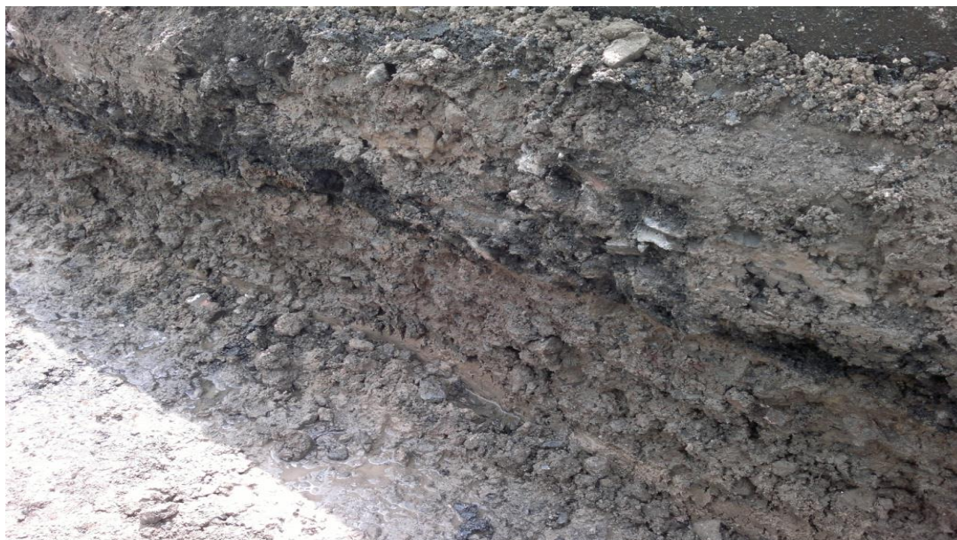
Figura 41 – Saturación y escurrimiento de agua a nivel de subbase y terracerías, septiembre de 2012.
