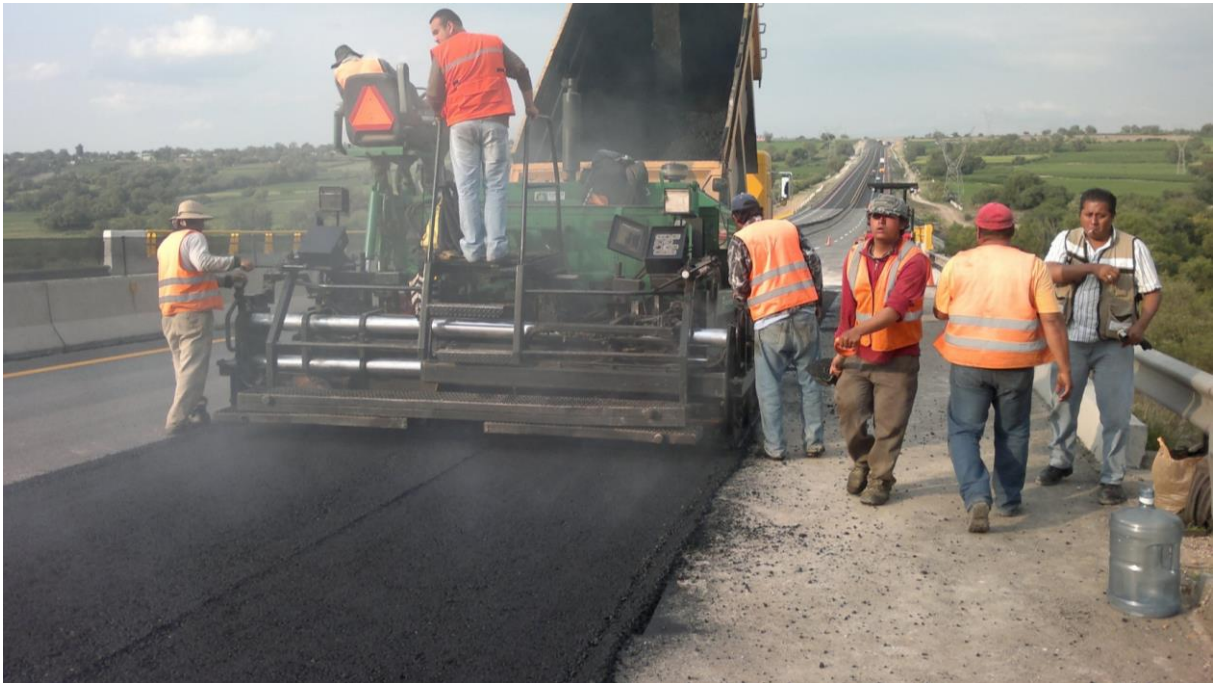
Figura 57 – Colocación de la capa de rodamiento en concreto asfáltico con AC-20 modificado con SBS.
