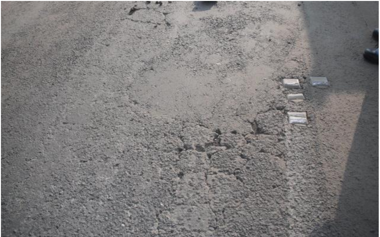
Figura 27 – Carpeta asfáltica km 51+250, abril de 2012.
