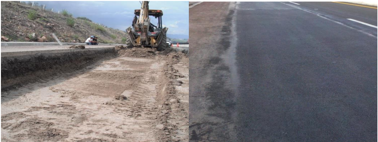
Figura 30 – Ejemplo de bacheo profundo (reposición de subbase, base y carpeta asfáltica), mayo de 2012.
