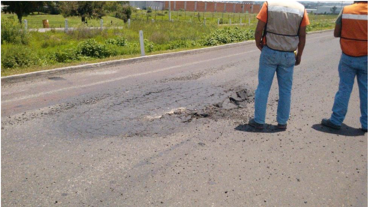
Figura 60 – Ejemplo de bache de rápido desarrollo en zona previamente rehabilitada con sobre carpeta.
