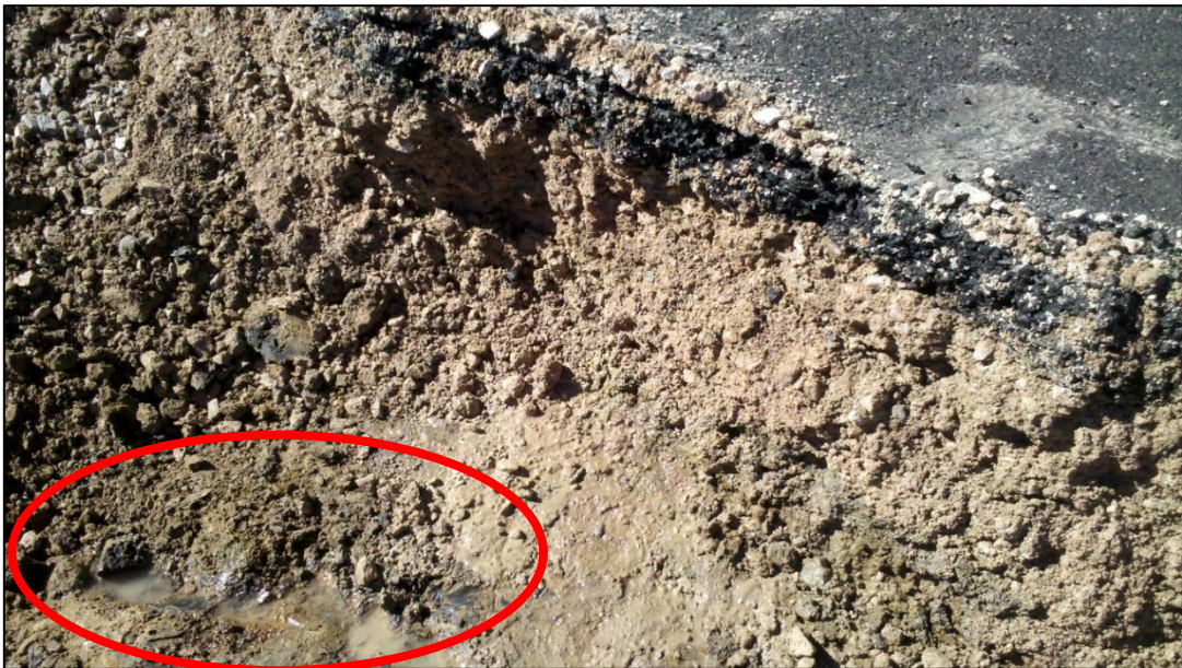
Figura 40 – Sondeo en capas de base y subbase con escurrimiento de agua, septiembre de 2012.
