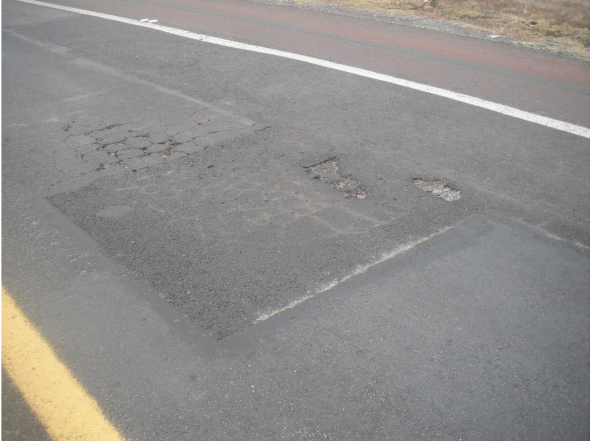
Figura 66 – Zona de pavimento fallada (primer plano) seguida de zona rehabilitada (fondo).
