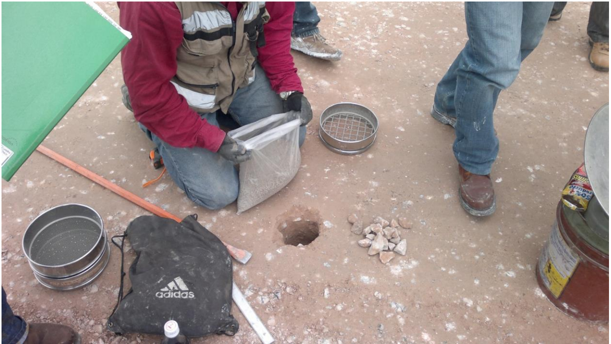
Figura 55 – Pruebas de control de compactación a materiales granulares hidráulicos en base y subbase.
