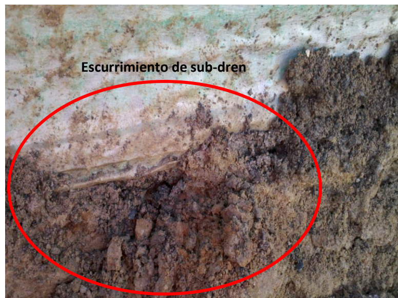
Figura 43 – Saturación y escurrimiento en los sub-drenes laterales, septiembre de 2012.
