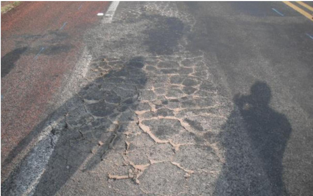
Figura 26 – Carpeta asfáltica km 51+200, abril de 2012.
