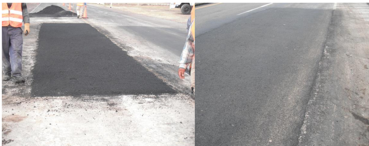
Figura 29 – Ejemplo de bacheo superficial (reposición de carpeta asfáltica), mayo de 2012.
