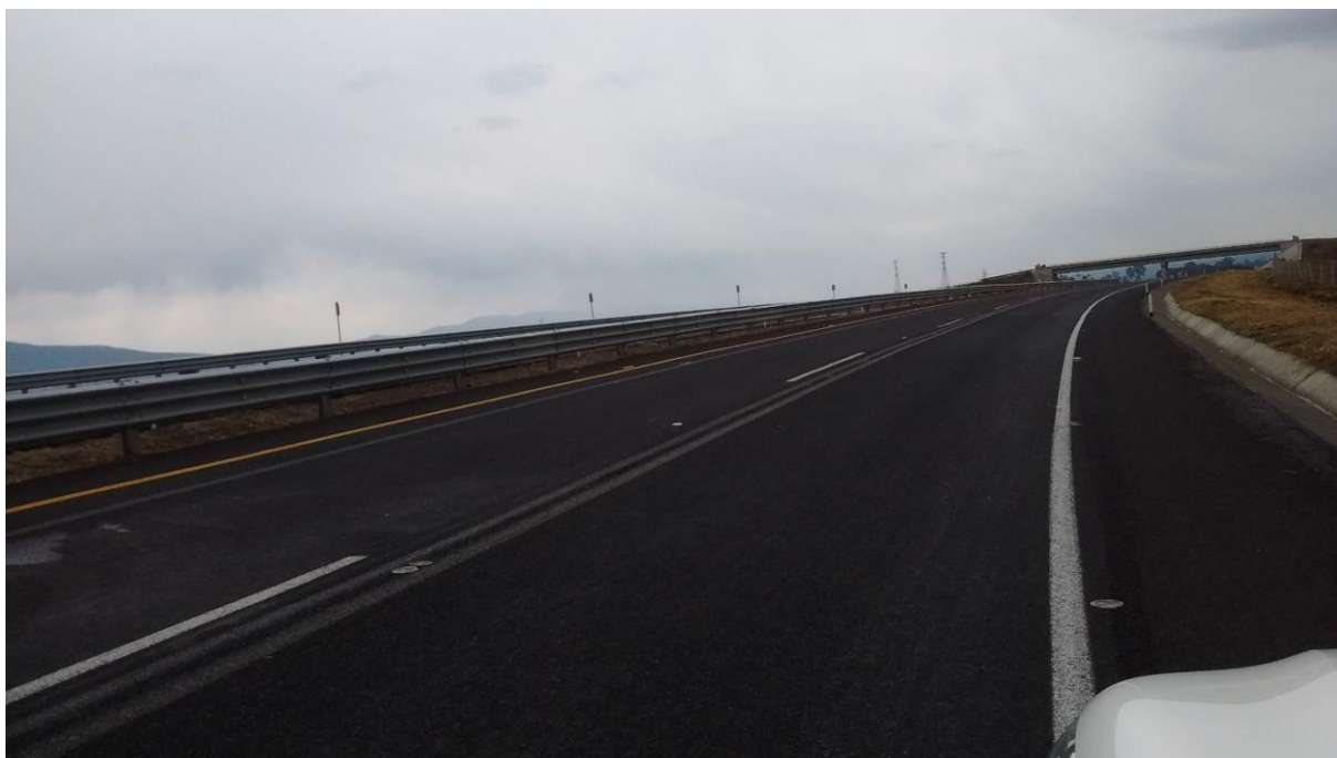
Figura 82 – Estado actual (mayo 2017) de sección de pavimento con estructura propuesta.
