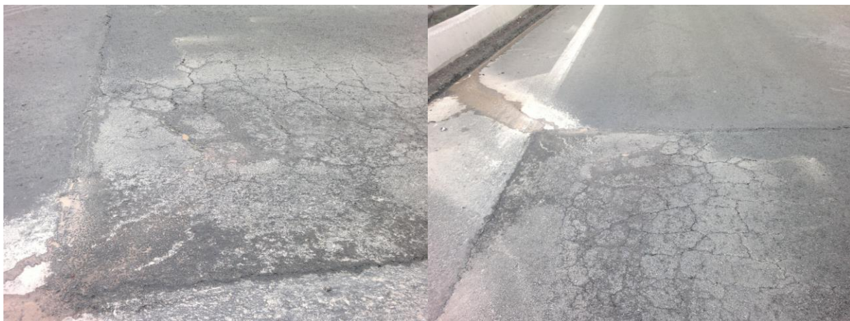
Figura 33 – Borde de zona bacheada fracturada con escurrimientos y pérdida de finos, agosto de 2012.
