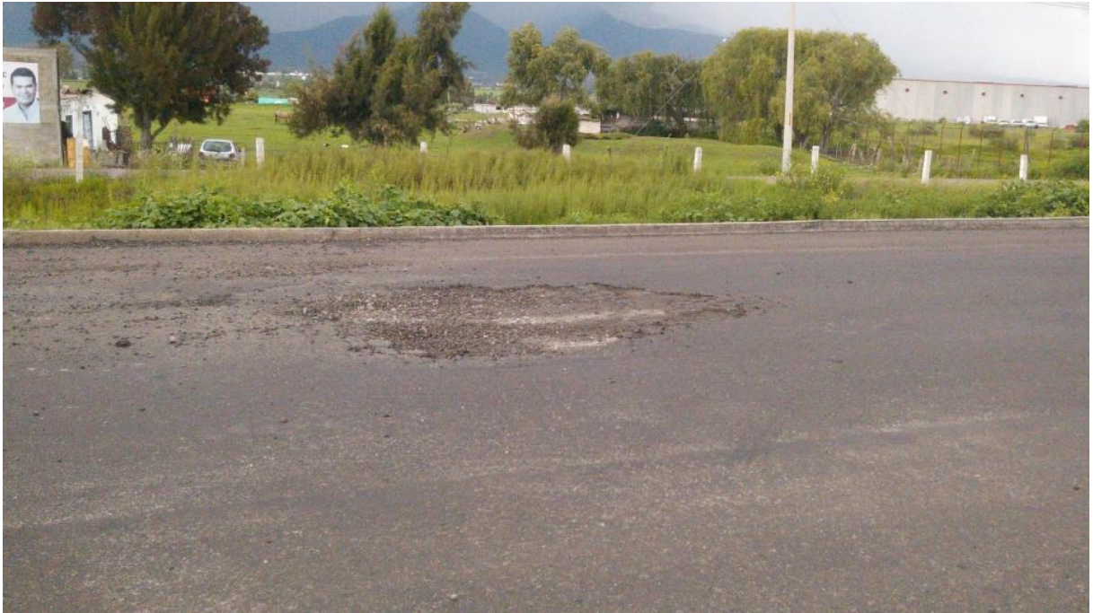
Figura 62 – Desintegración de la carpeta asfáltica en zona con bacheo profundo y sobre carpeta.
