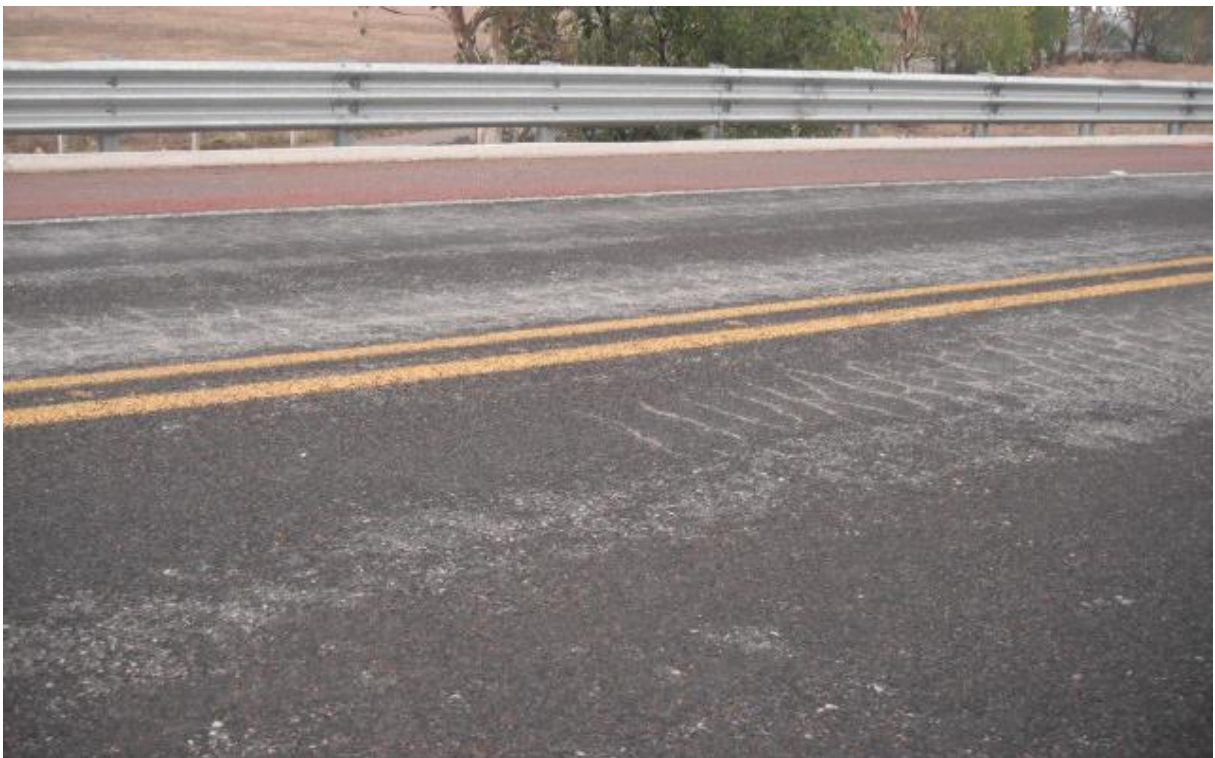
Figura 23 – Carpeta asfáltica en el km 47+000 al km 53+000 del cuerpo único, abril de 2012.
