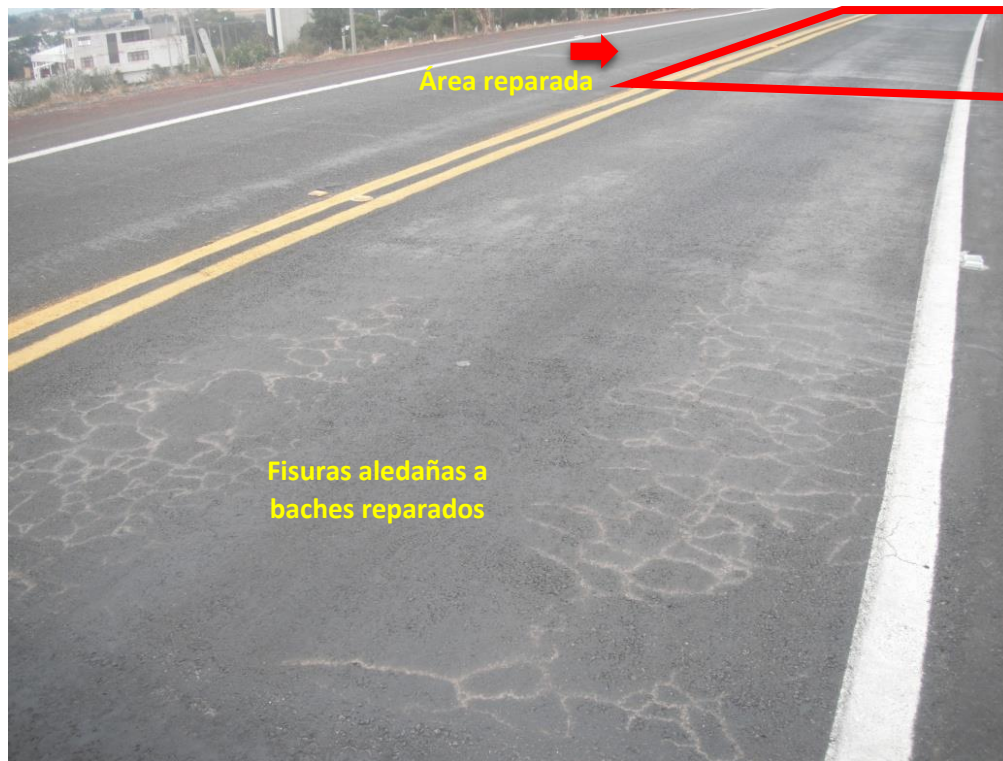
Figura 65 – Zona de pavimento fallada (primer plano) seguida de zona rehabilitada (fondo).
