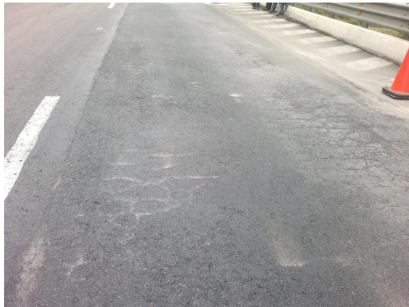
Figura 31 – Carpeta asfáltica con piel de cocodrilo apenas 3 meses después de rehabilitada, agosto de 2012.
