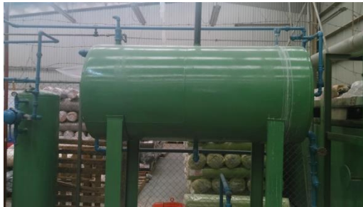
Ilustración 12 Tanque de alimentación de agua
