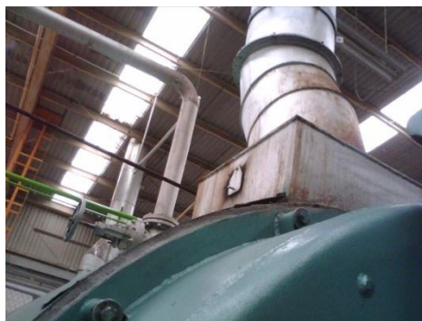
Ilustración 16 Chimenea de gases de combustión
