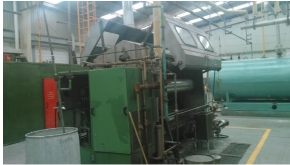
Ilustración 11 Jigger sin mantenimiento
