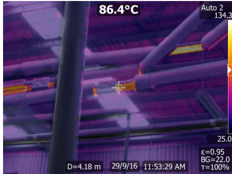
Ilustración 26 Partes de la tubería sin aislante
