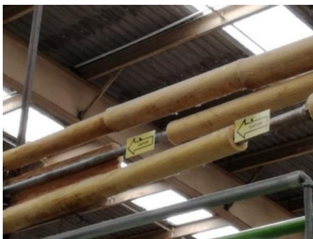
Ilustración 23 Aislante de tuberías ineficiente
