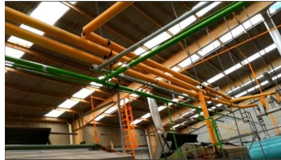
Ilustración 25 Línea de distribución de vapor
