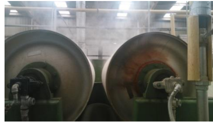
Ilustración 7. Inyección de vapor
