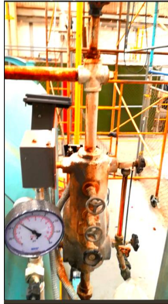
Ilustración 27 Desgaste en las Válvulas
