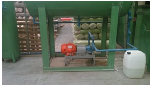
Ilustración 13 Fuga en la tubería.
