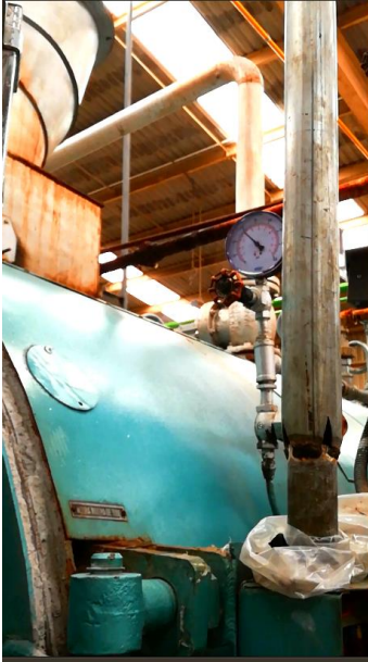
Ilustración 28 Fugas de vapor
