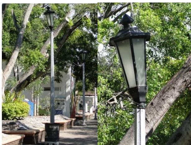
Fotografía 3. Luminarios de alumbrado general. Potencia 250 [W], tecnología de vapor de sodio a alta presión.
