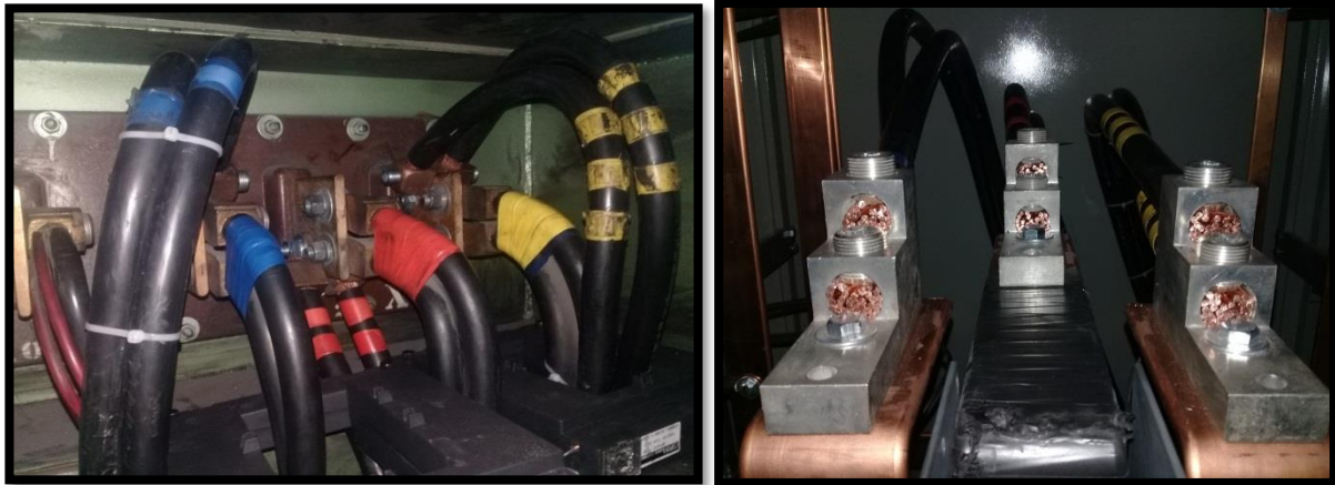
Lado secundario de TR de 750 KVA. Llegada al interruptor del equipo A-03127
