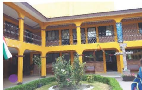
Claustro, que sirve como un vestíbulo exterior que distribuye a las diferentes aulas dentro del seminario.
